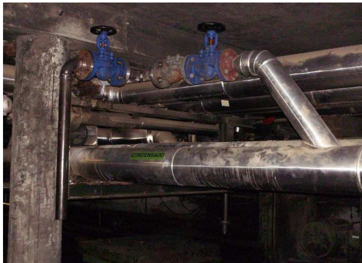
Figura 3.23 - Alterações na linha de saída de condensado da Râmula Monforts2, de forma a permitir contabilizar o condensado produzido.
