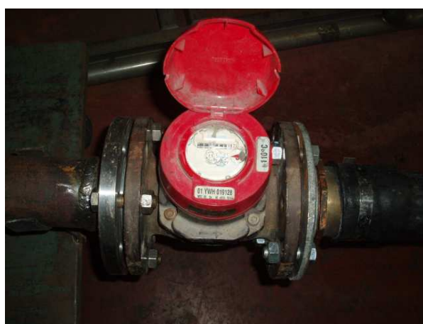
Figura 3.27 - Contador de água quente.
