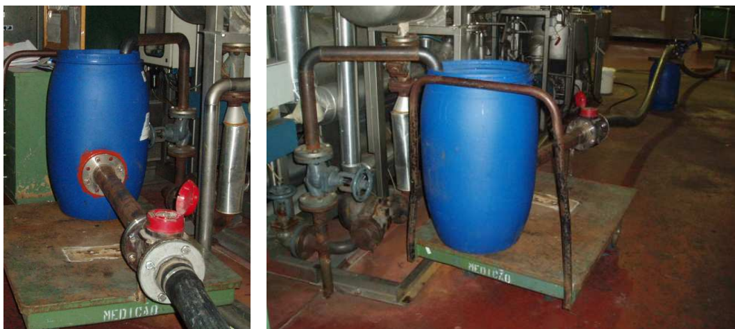
Figura 3.26 - Instrumentação para medição de condensado, idealizada e construída para este projecto.
