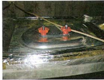
Figura 19 – Tampa de visita em conduta para permitir a sua limpeza
