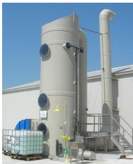
Sistema de Desodorização
