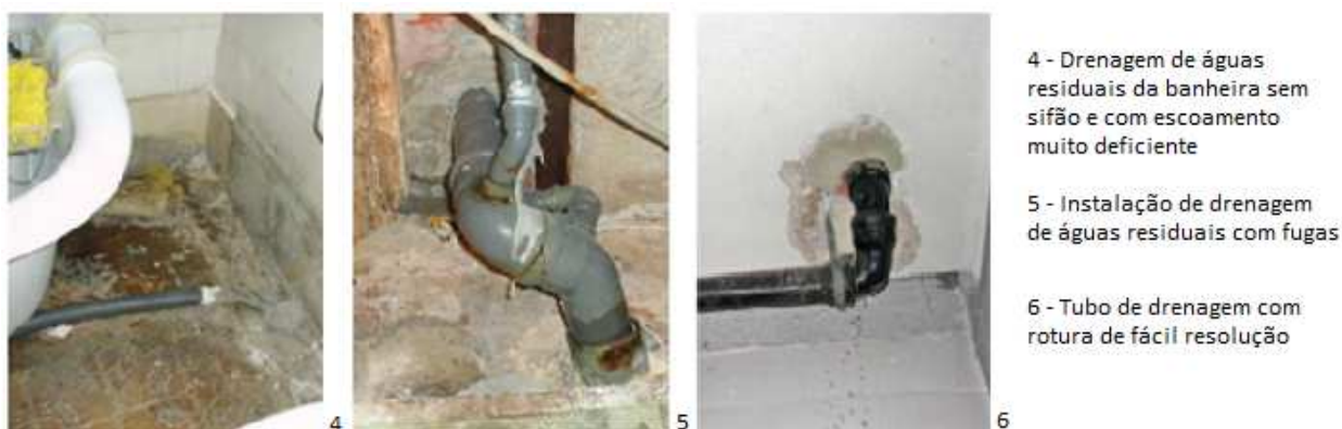
Figura 6.7 – Exemplos de anomalias graves em redes de drenagem de águas residuais domésticas (MAEC,2007).
