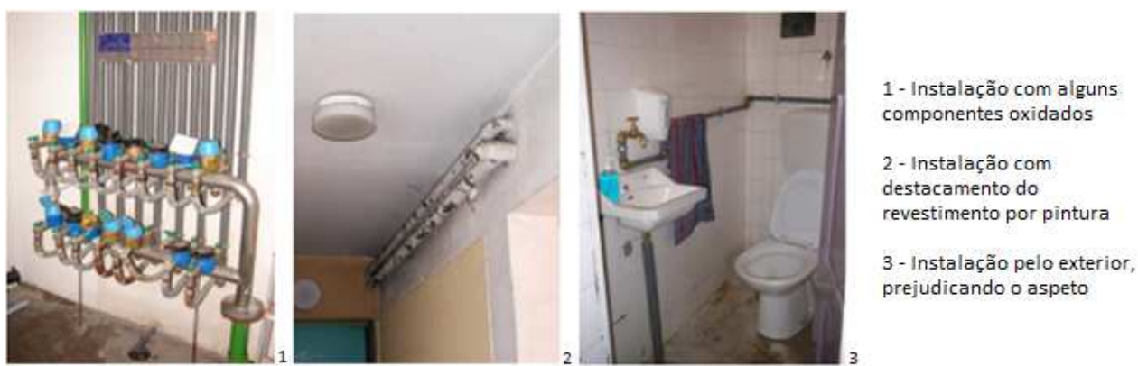
Figura 6.1 – Exemplos de anomalias ligeiras em redes de abastecimento de água (MAEC,2007).
