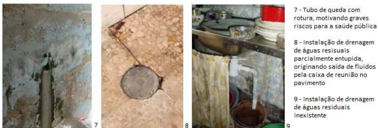
Figura 6.8 – Exemplos de anomalias muito graves em redes de drenagem de águas residuais domésticas (MAEC,2007).
