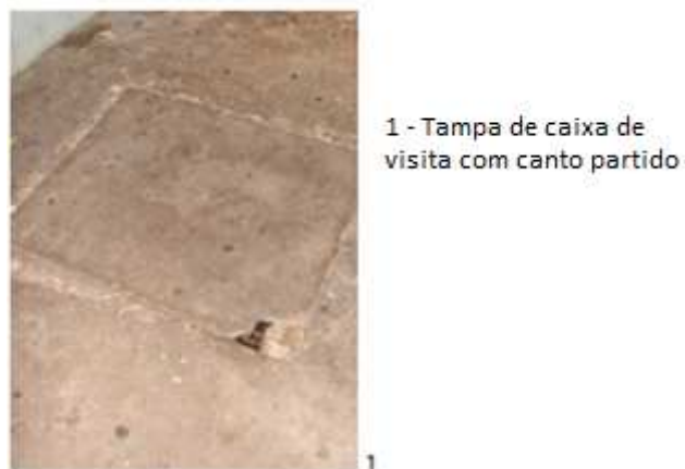
Figura 6.5 – Exemplo de anomalia ligeira em rede de drenagem de águas residuais domésticas (MAEC,2007).
