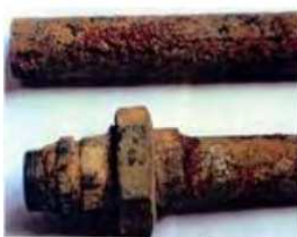
Corrosão pelo exterior
