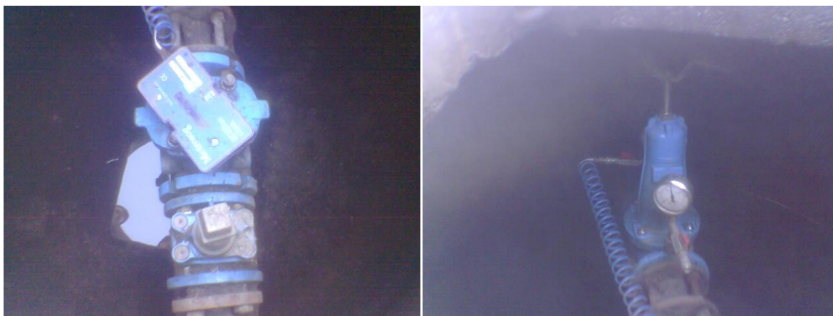
Figura 61: Caixa de recepção da VRP em Covelas no R12. Data-loggers na VRP; VRP com Manómetro de pressão acoplado.
