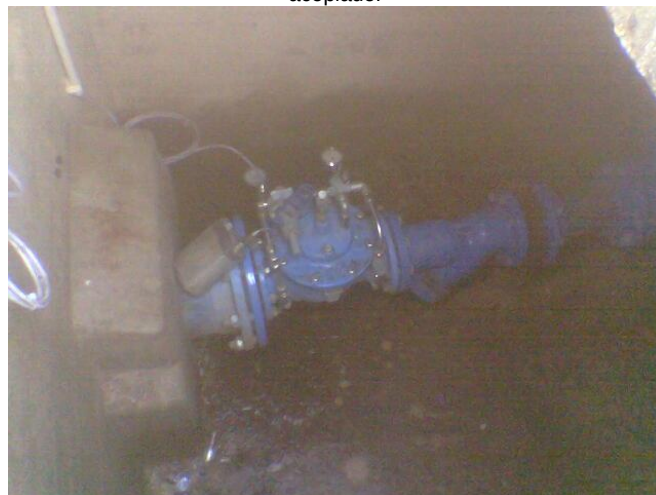
Figura 62: Caixa de recepção da VRP em S. Mamede do Coronado no R12. Data-loggers na VRP; VRP com filtro e sedimentador de partículas a montante para purga desses mesmos materiais.
