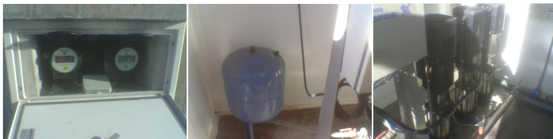
Figura 93: Sistema pressurizado do R12 (Caudalímetros; Reservatório regulador/igualizador das bombas; 3 Bombas de rotação variável).
