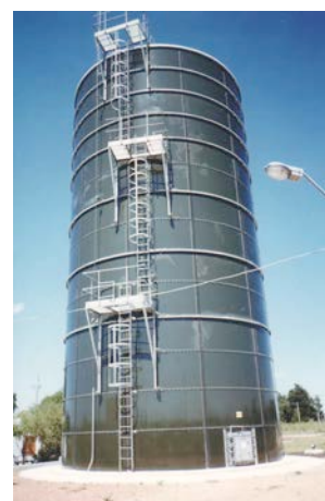
Fig 6.7 - Chaminé de equilíbrio de aço em Montevidéu, Uruguai [23]
