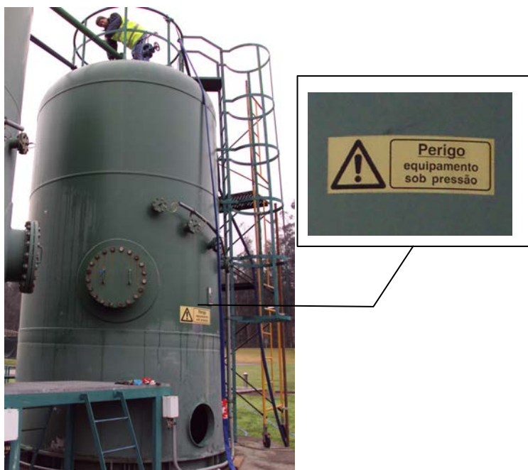
Fig.7.3 –Reservatório de Ar Comprimido da ETA de Areias de Vilar sujeito a operação de fiscalização. Pormenor de inscrição.
