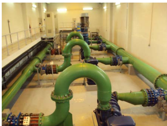
Fig.8.6 – Fotografia do interior da estação elevatória de Barradas . À esquerda – ramal de Cerite; à direita – ramal de Joane e Stº Tecla
