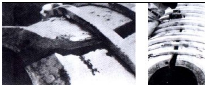
Fig.4.3 – Na Central Hidroelétrica em Big Creek, nos Estados Unidos, deu-se a rotura de uma conduta devido às variações de pressão [13].
