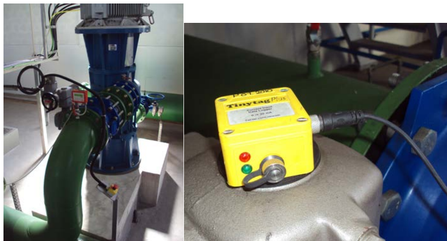
Fig.8.12 – Equipamentos de medição instalados na conduta de compressão
