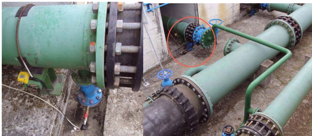
Fig.8.15 – Instalação de um datalogger na conduta de ligação ao RAC
