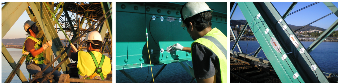
FIGURA 3.39: Vistas gerais da instalação dos sensores de Bragg na Ponte Eiffel.
