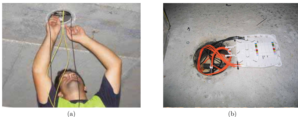
FIGURA 5.52: Utilização das caixas de acesso para realização das ligações: a) acesso aos cabos ópticos após a betonagem; b) acondicionamento das emendas de fibra junto à caixa de acesso.
