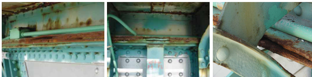
FIGURA 3.37: Sinais de corrosão avançada instalada nas cordas junto do tabuleiro superior da ponte.
