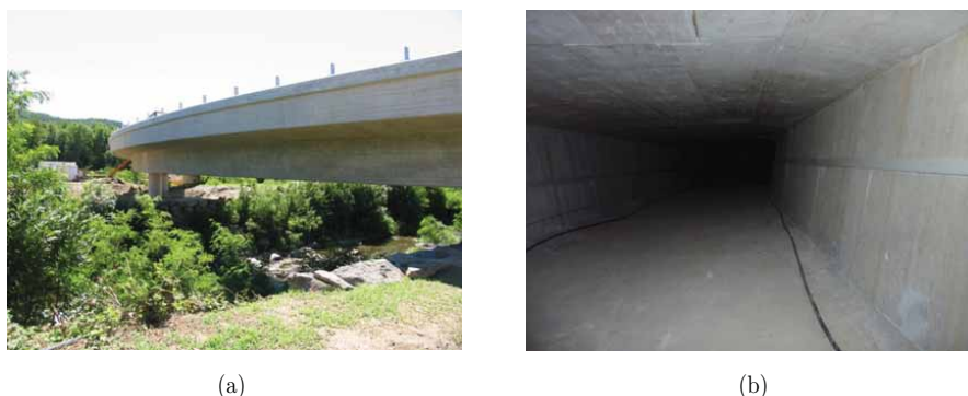
FIGURA 4.32: Vistas gerais da Ponte Ricciolo, servindo a Auto-estrada A2, na Suíça: a) vista exterior do tabuleiro curvo; b) vista do interior do caixão.
