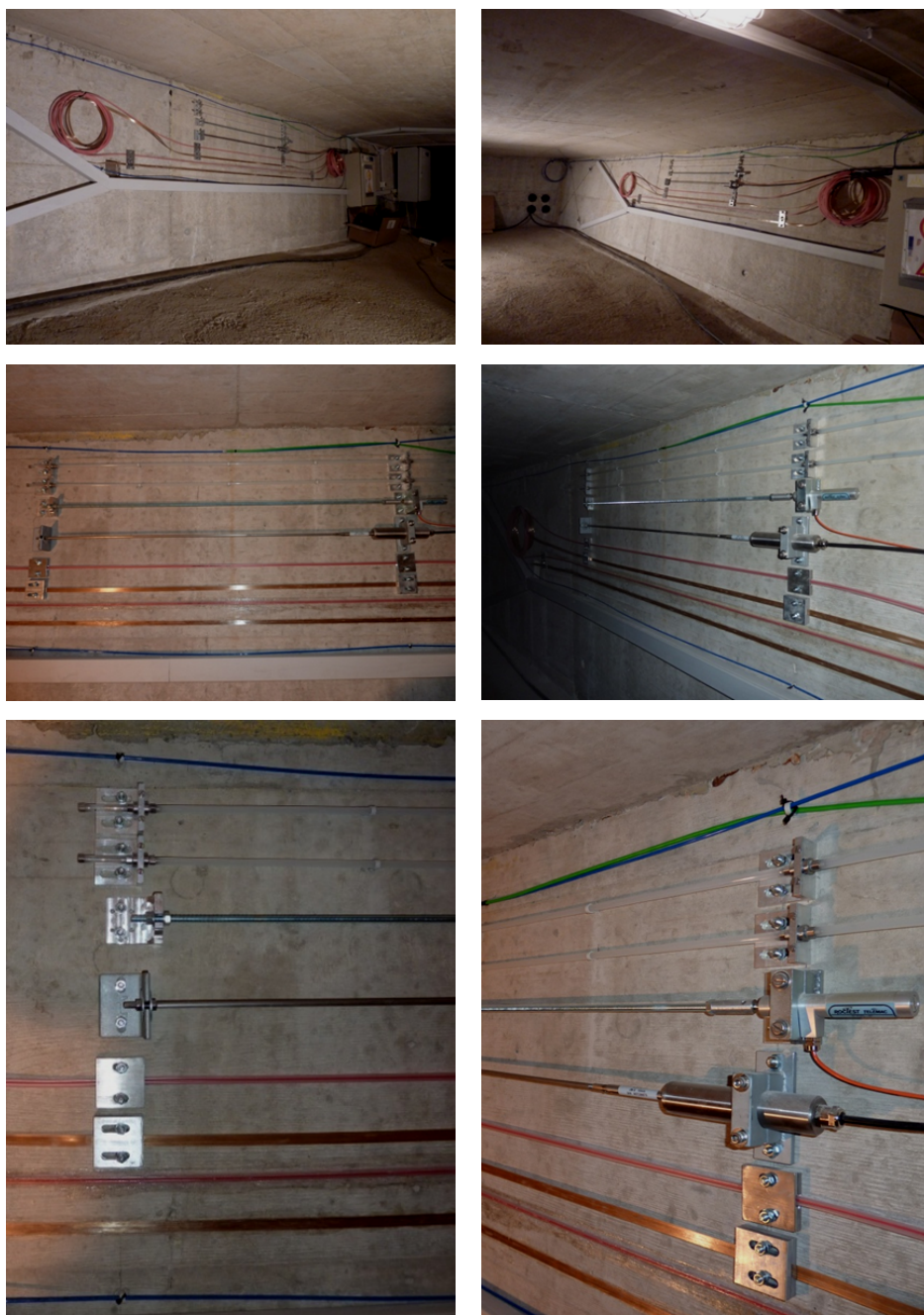
FIGURA 4.28: Vistas gerais da instalação dos vários transdutores de deformação, em paralelo, numa secção transversal da Ponte Ricciolo, na Suíça.
