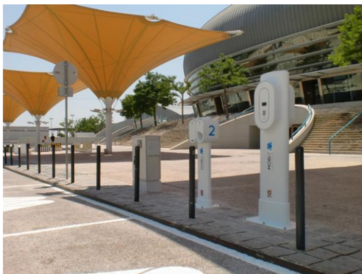
Figura 4.4 - Posto de carregamento na via pública [44].
