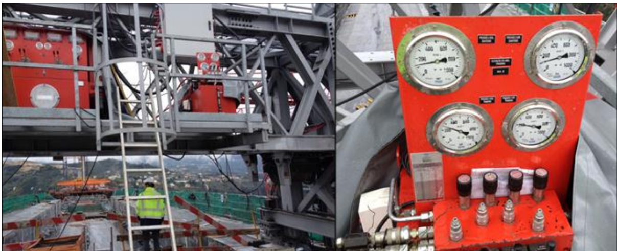
Fig. 3.4.6 – Sistema de controlo do OPS, em Viaduto do Corgo.
