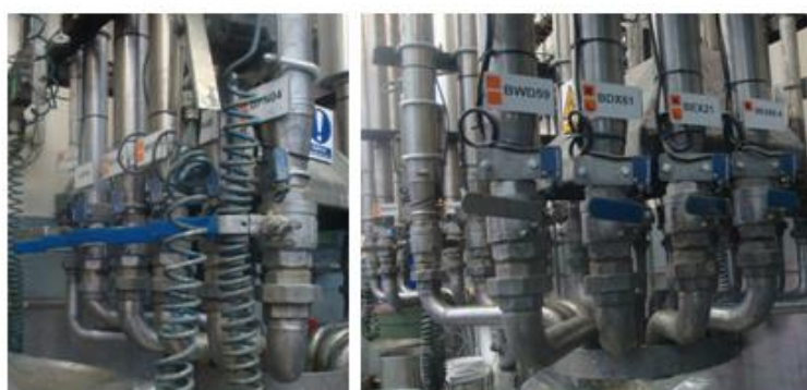
Figura 25 – Alavancas de abertura das válvulas do lado direito e esquerdo do sistema rack
