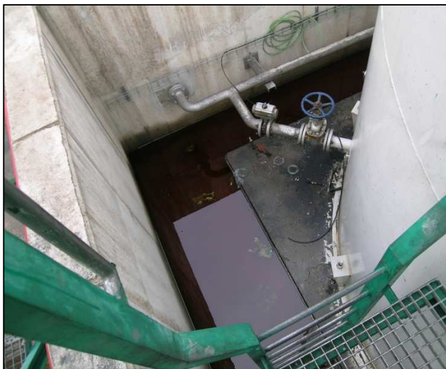
Figura 25. Caleira da bacia de retenção da zona de armazenamento de biodiesel.
