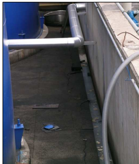
Figura 26. Caleira da bacia de retenção da zona de armazenamento de óleos e glicerina.
