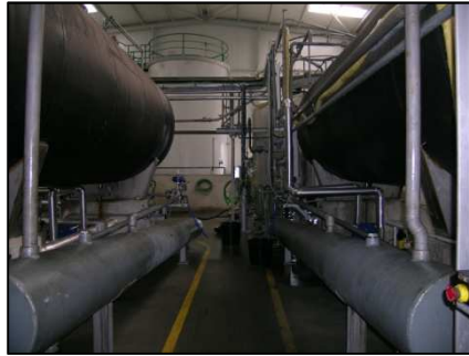
Figura 9. Depósitos D06 e D08 (esquerda) e depósitos D07 e D09 (direita).
