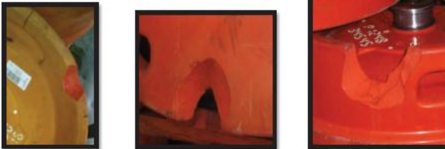
Figura 5.13.1 – Barril de poliuretano com falta de material, superficial sem chegar ao metal, classificados como Satisfatório, Aceitável e Não Satisfatório respectivamente.
