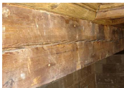
Figura 3.41 - Pormenor de uma fenda longitudinal (Pereira, 2009)
