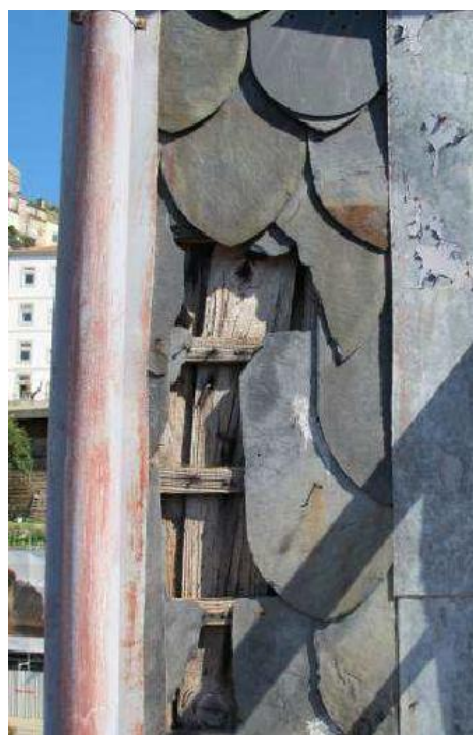
Figura 5.26 – Falta de elementos de recobrimento da fachada (Parede 1)
