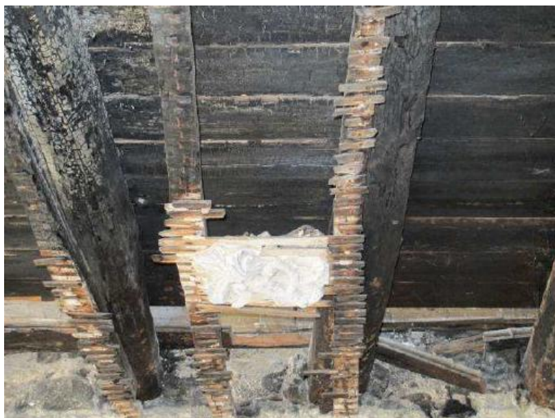
Figura 5.46 – Pavimento do piso 2 carbonizado
