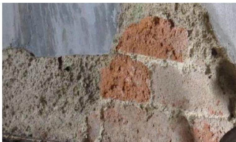
Figura 5.34 - Desagregação granular de elementos de tijolo maciço
