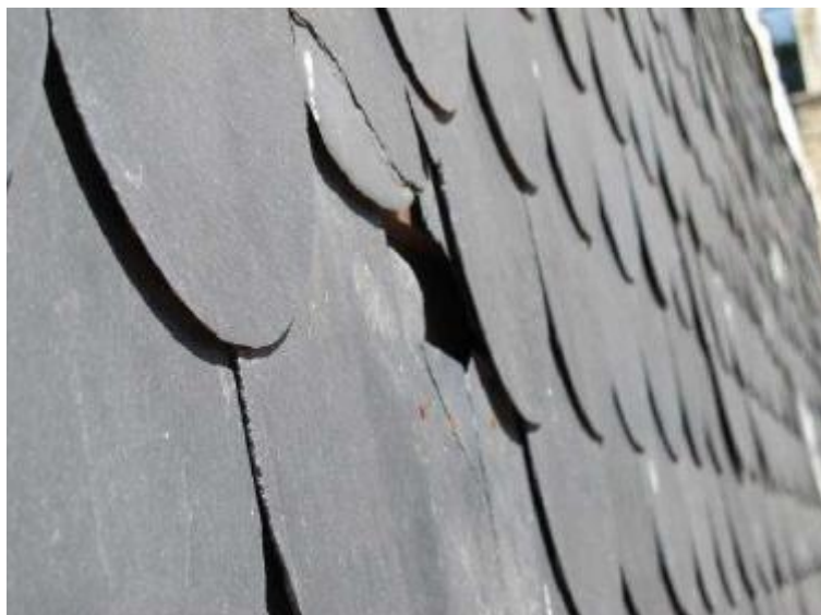
Figura 5.36 - Parede 2 com falta de soletos de ardósia
