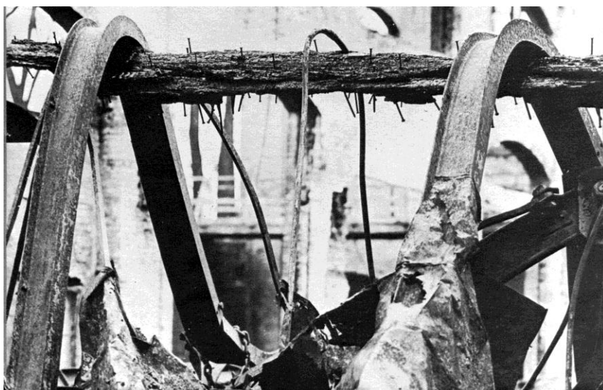
Figura 2.6 - Estrutura metálica completamente deformada suportada por uma viga de madeira após incêndio ([5])
