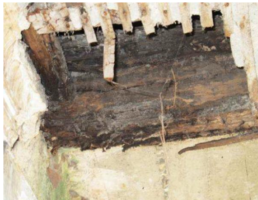
Figura 5.50 – Presença de fungos de podridão na zona de apoio das vigas
