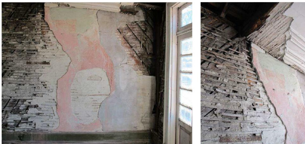
Figura 5.35 - Parede de tabique degradada no piso 3
