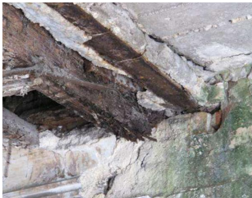
Figura 5.49 – Degradação dos perfis metálicos no piso 3
