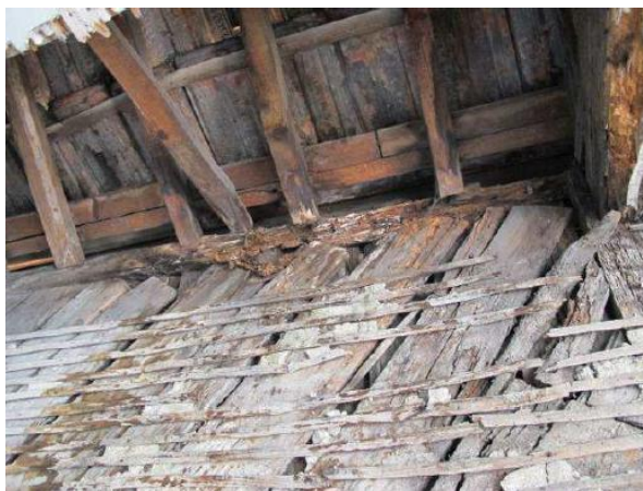
Figura 5.54 – Pormenor de apoio da cobertura na parede de tabique, com degradação intensa na zona de apoio
