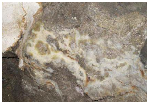
Figura 5.31 - Fungos presentes em blocos de granito no piso -1
