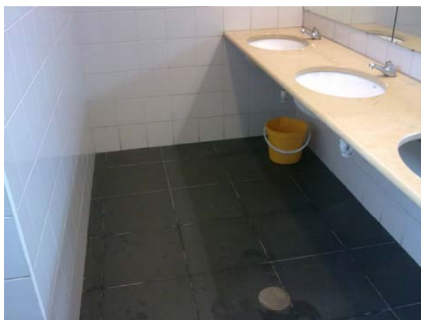
Fig.7.24. – Ladrilhos cerâmicos em instalação sanitária do edifício X
