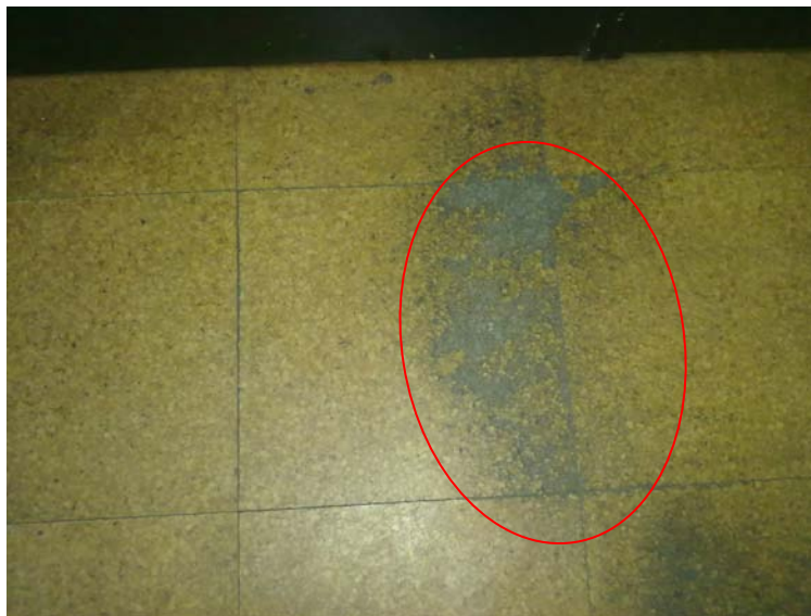
Fig.4.36. – Revestimento de aglomerado de cortiça com sinais de desgaste superficial
