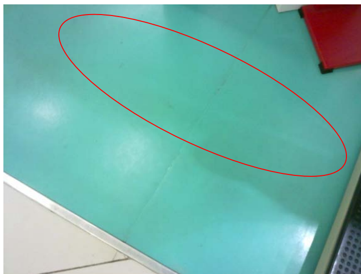
Fig.4.59. – Revestimento vinílico apresentando alterações na cor e brilho
