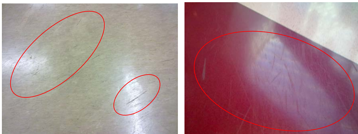
Fig.4.55. – Revestimento de linóleo exposto à riscagem superficial
