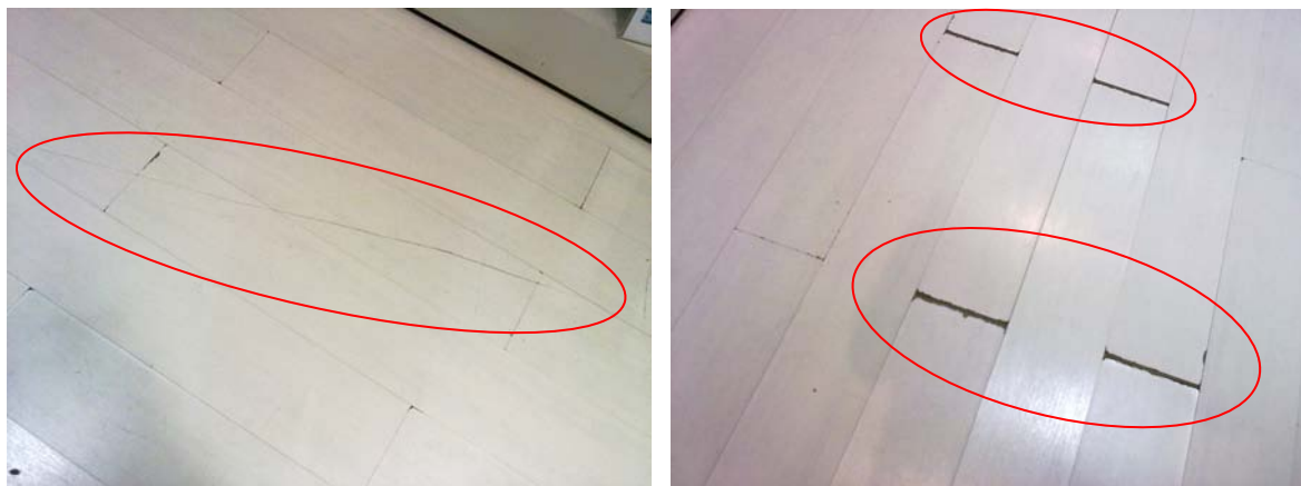
Fig.4.31. – Exposição à riscagem e degradação das juntas
