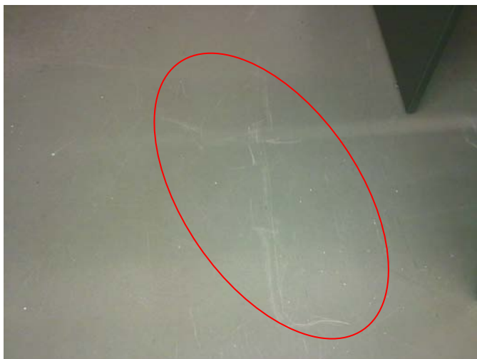
Fig.4.61. – Revestimento em resina de epóxi apresentando riscagem, alterações na cor e brilho
