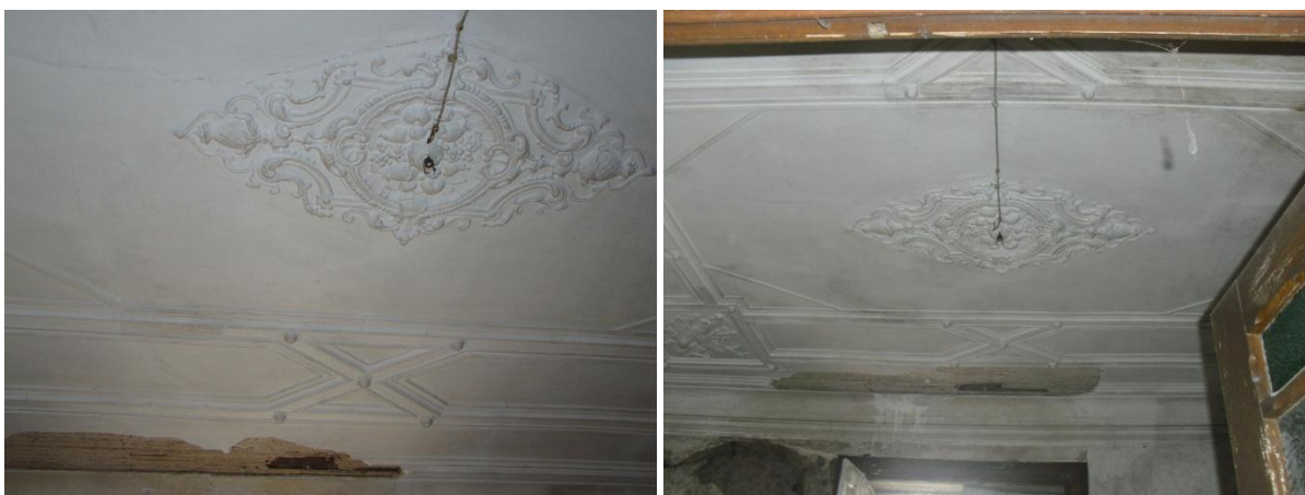
Figura 3.75 – Comparativo de queda de material no tecto do piso 0 em 2009 e em 2011
