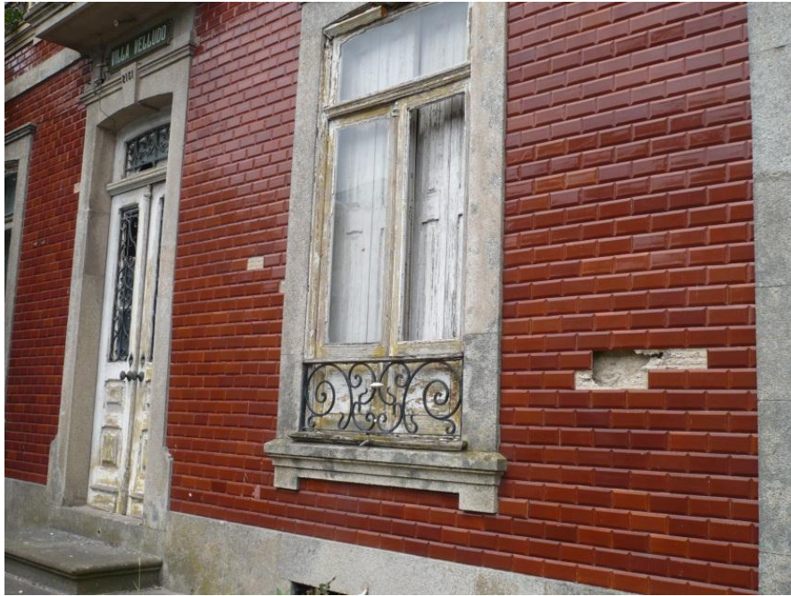
Figura 3.57 - Queda de azulejo na fachada principal
