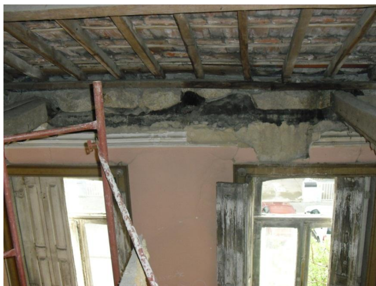
Figura 3.47 – Degradação da cobertura junto à fachada principal
