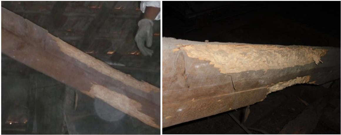
Figura 3.67 - Ataque caruncho num elemento da cobertura em 2009 e em 2011
