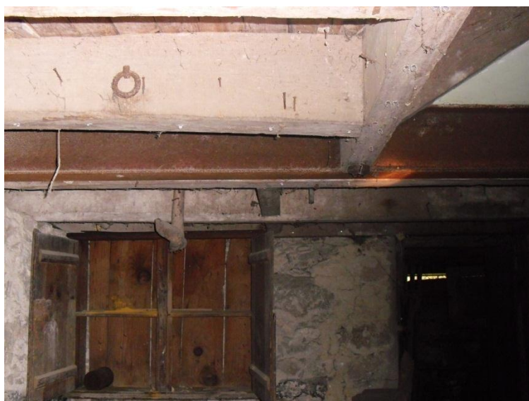
Figura 3.45 – Corrosão da viga metálica do nível 0
