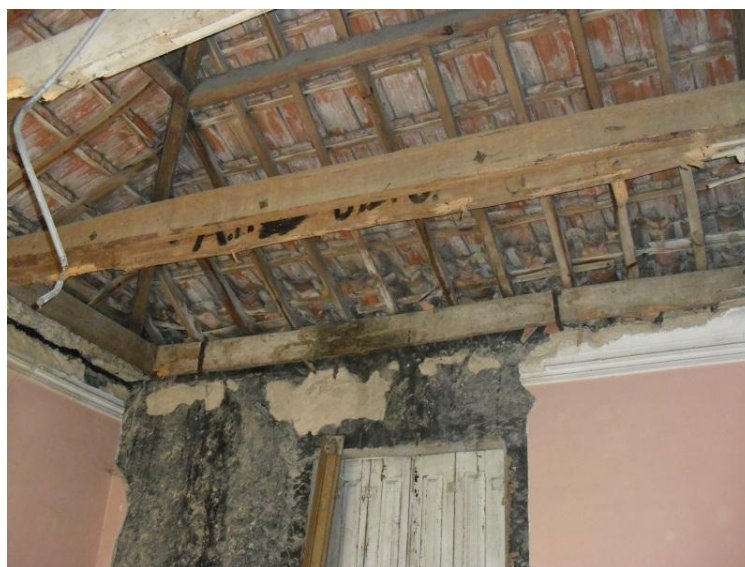
Figura 3.54 – Degradação dos elementos de suporte do tecto do nível 1
