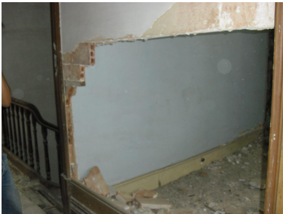
Figura 3.56 – Destruição da parede divisória do piso 1
