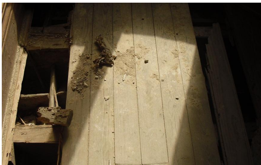
Figura 3.14 – Abertura no pavimento do piso 1
