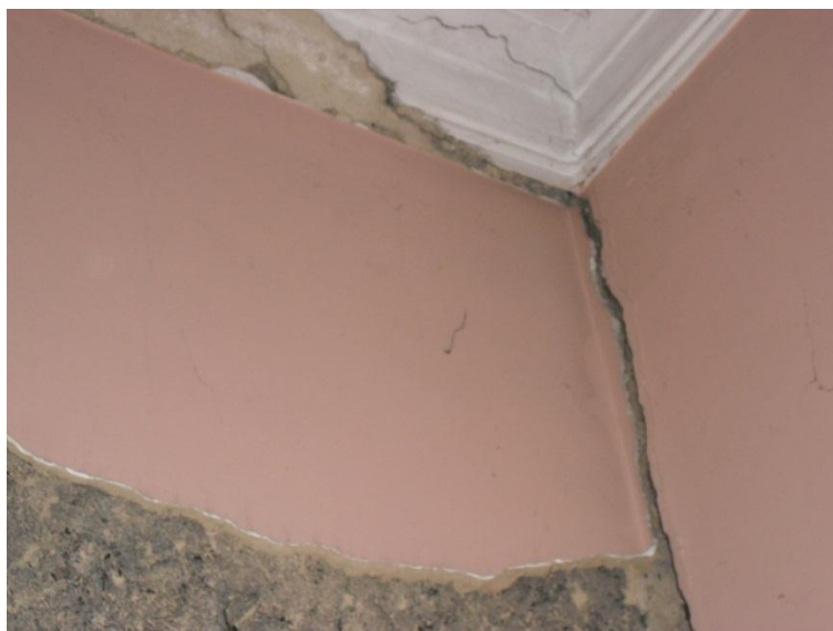
Figura 3.46 – Fissura de separação entre a parede de fachada principal e a interior que lhe é adjacente no nível 1
