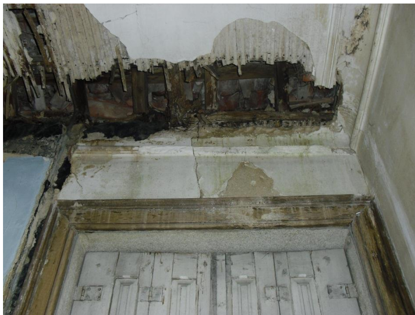
Figura 3.53 – Queda do tecto no nível 1
