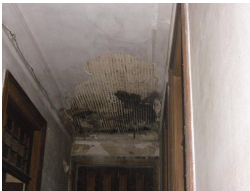
Figura 3.52 – Degradação do estuque e do fasquiado do tecto do nível 1
