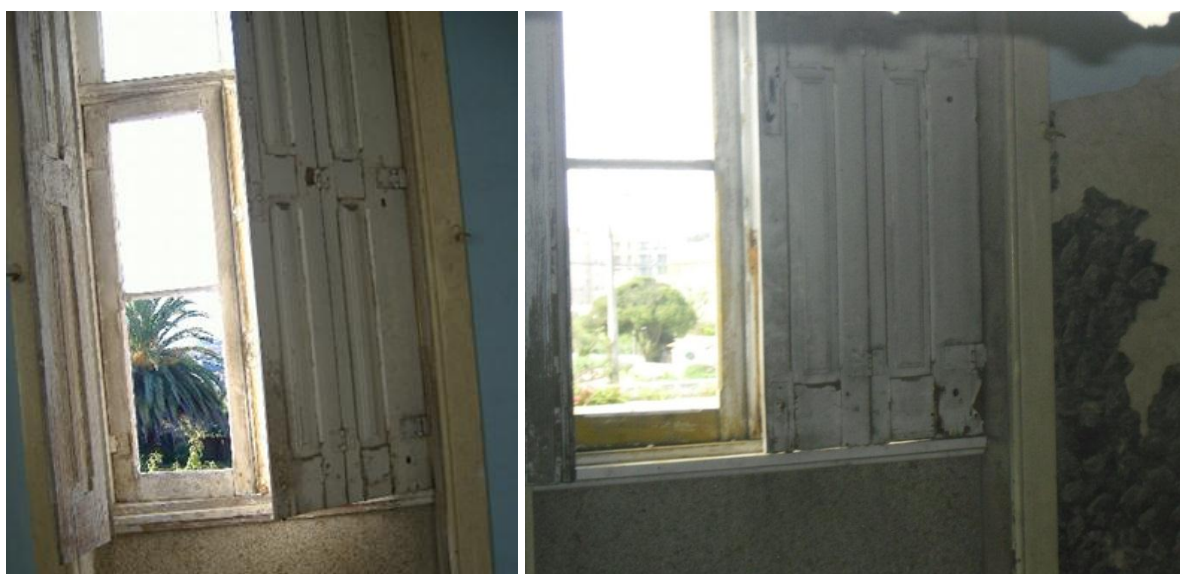
Figura 3.80 - Caixilharia numa janela do piso 1 em 2009 e em 2011
