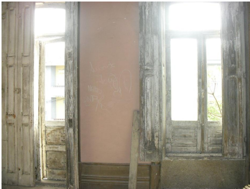
Figura 3.55 – Danos nas caixilharias exteriores
