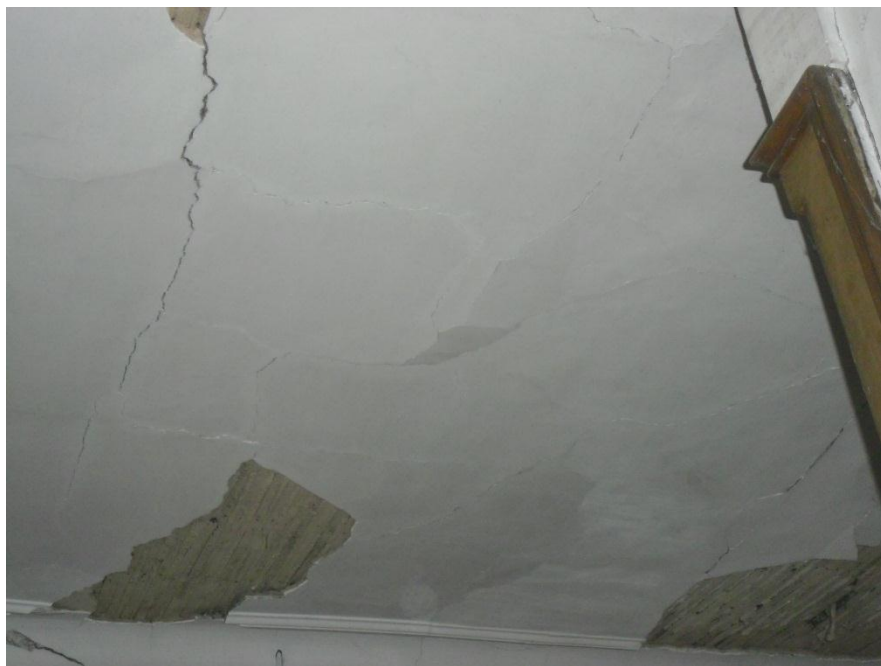
Figura 3.51 – Degradação do estuque do tecto do nível 0
