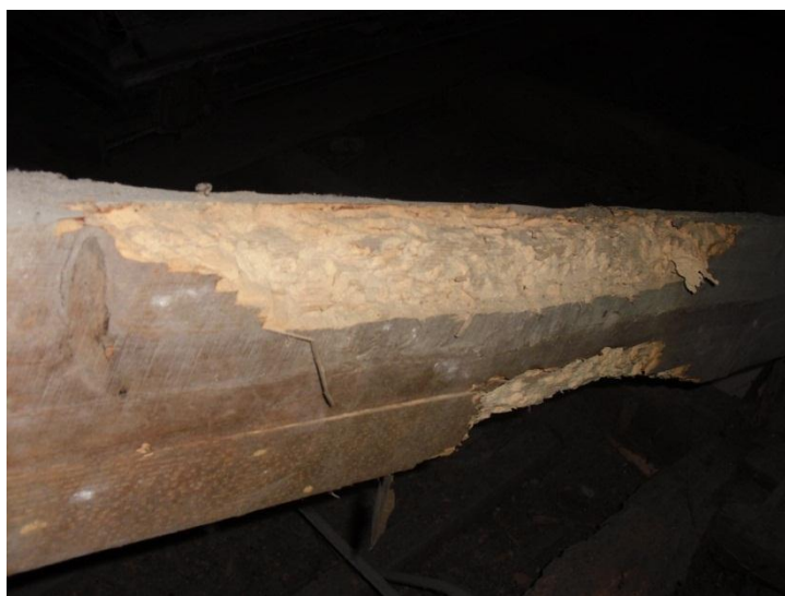
Figura 3.44 – Degradação nos elementos da cobertura (ataque de caruncho)
