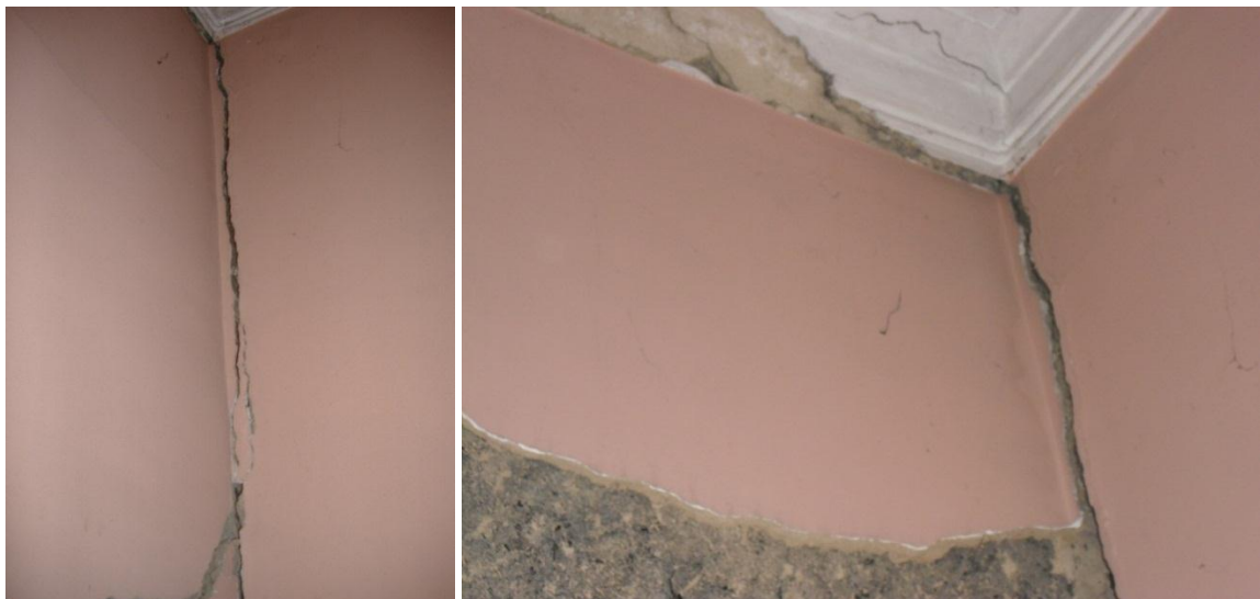
Figura 3.74 – Comparativo da fissura resultante da rotação da parede de fachada principal em 2009 e em 2011
