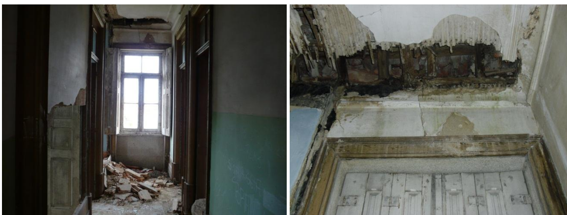
Figura 3.76 – Comparativo de queda de material no tecto do piso 1 em 2009 e em 2011
