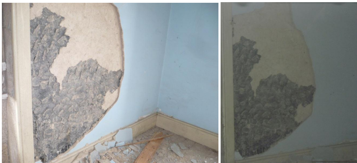
Figura 3.77 – Comparativo de queda de reboco numa parede do piso 1 em 2009 e em 2011
