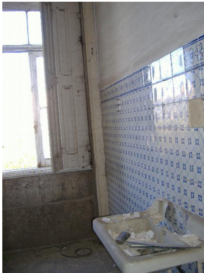
Figura 3.58 – Queda de azulejos na casa de banho
