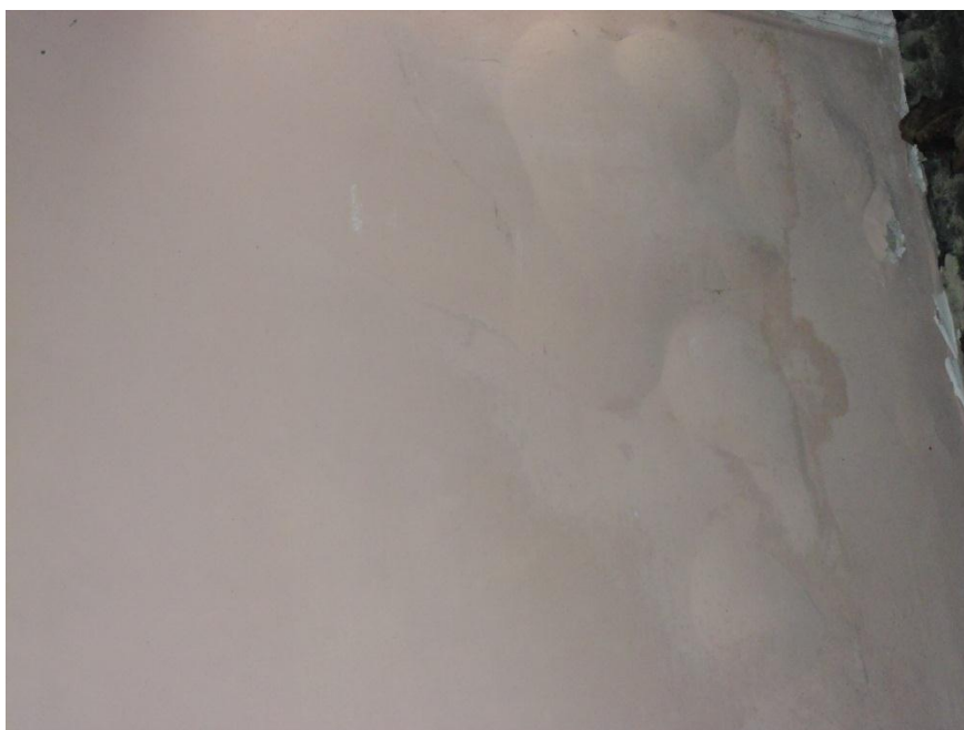
Figura 3.50 – Empolamento numa parede do nível 1
