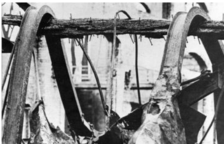
Fig. 11 – Viga de madeira após incêndio
