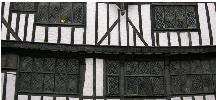
Fig. 14 – Deformação excessiva de viga de madeira
