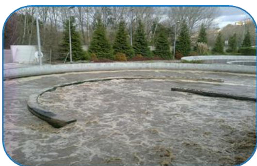
Figura 12 Zona óxica do tanque de tratamento
