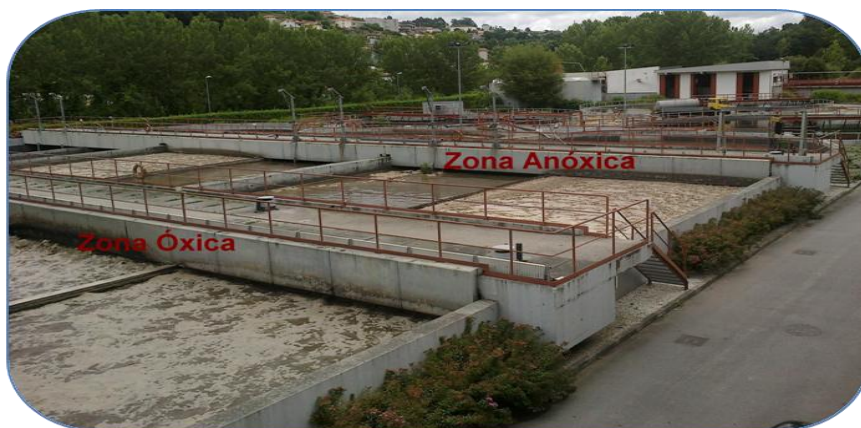
Figura 11 Tipo de reator de tratamento biológico – Vala de oxidação, na ETAR do Febros
