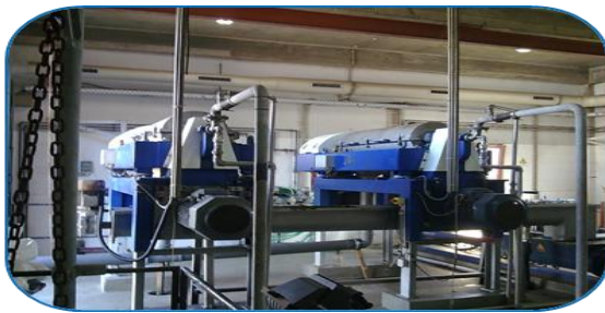
Figura 17 Centrífugas de desidratação
