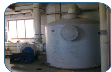
Figura 19 Sistema de desodorização
