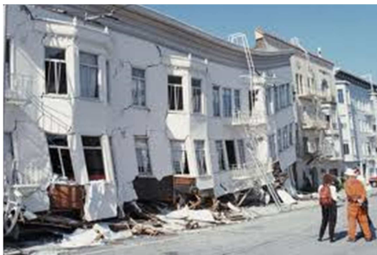
Figura 2.1 – Danos provocados em edifícios em banda devido ao sismo de Loma Prieta
