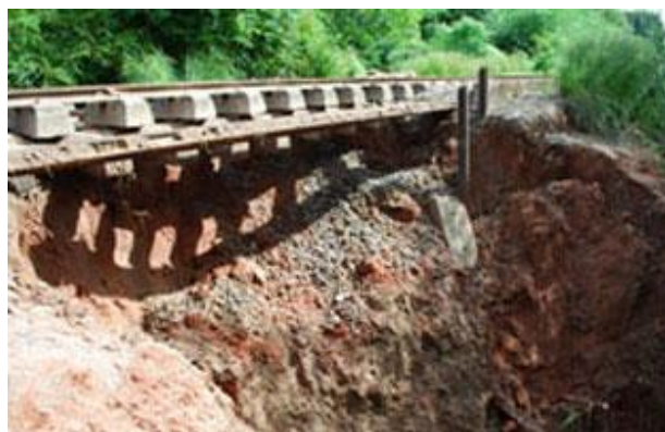
Fig. 37 – Exemplo de falhas no sistema de drenagem de uma via-férrea (webtranspo, 2009)
