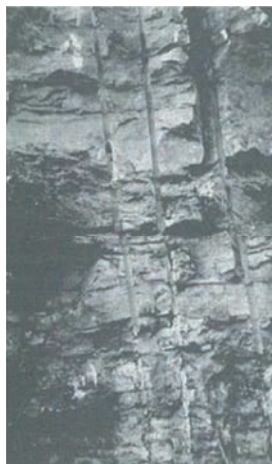
Fig. 5.11 – Furos desalinhados na face do talude (meias canas) (Jimeno et al.,2003)
