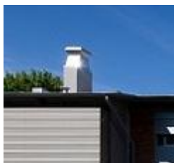
Figura 12 – Sistema de exaustão das Cozinhas.
