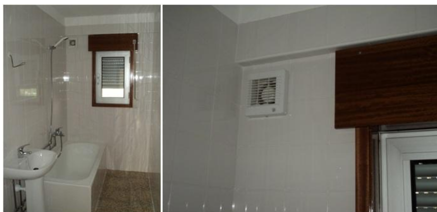
Figura 11 – Extração mecânica na Instalação sanitária.
