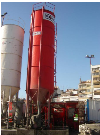
Fig. 3.15 - Silo de cimento (Rodrigues, 2009)
