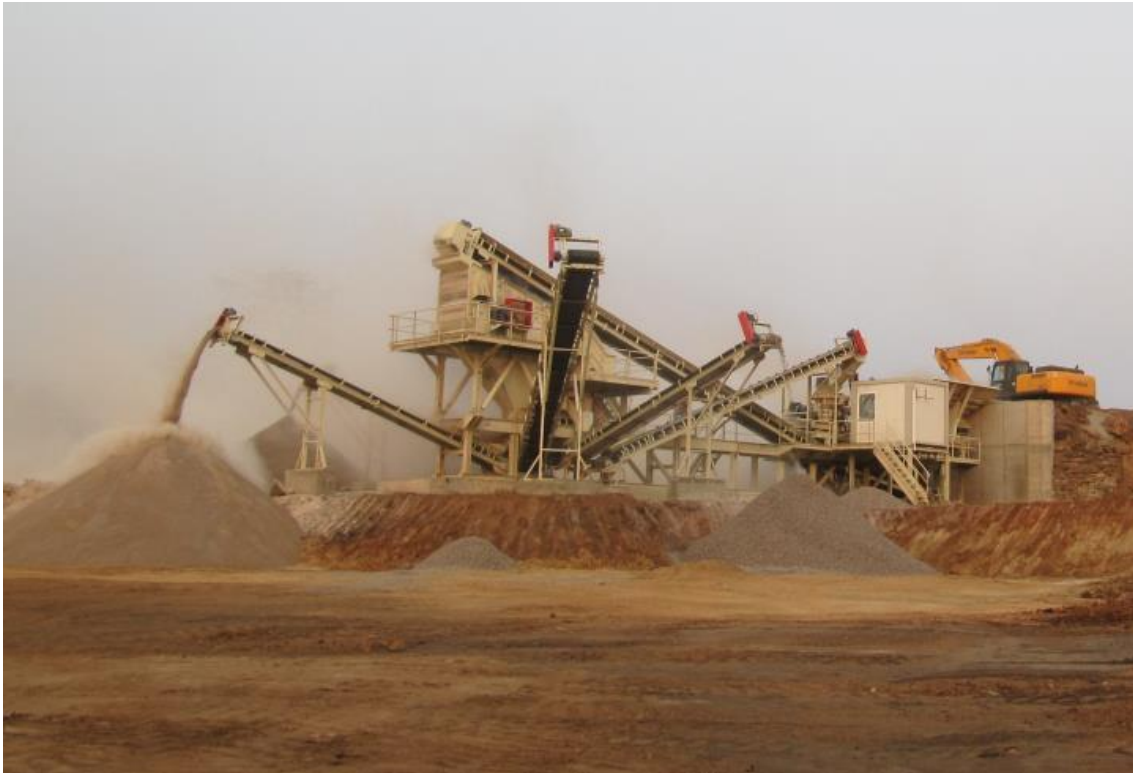
Figura 1 – Instalação de britagem
