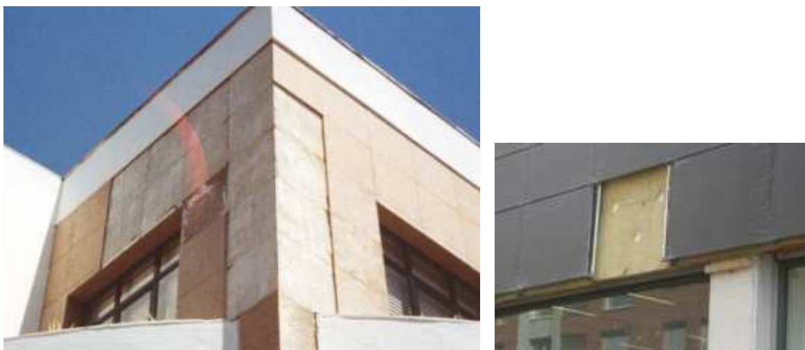
Fig. 2.34 – Queda de painéis de revestimento.
