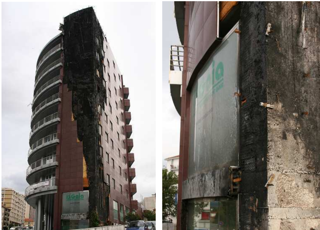
Fig. 3.1 – Abril 2008, Prédio em V.N. Gaia após extinção do incêndio.
