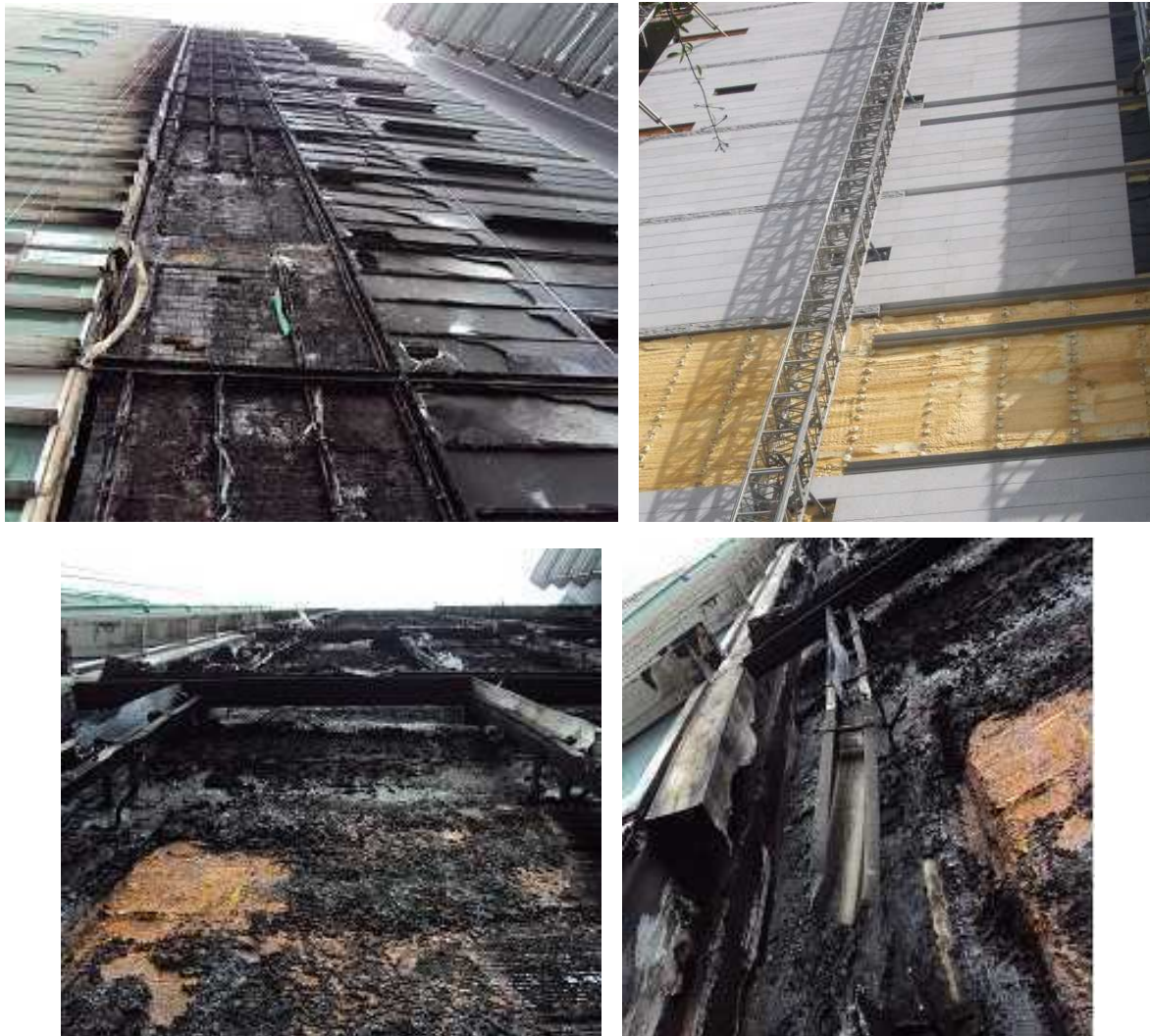
Fig. 3.3 – Pormenores de prédio em Lisboa após ocorrência de incêndio.
