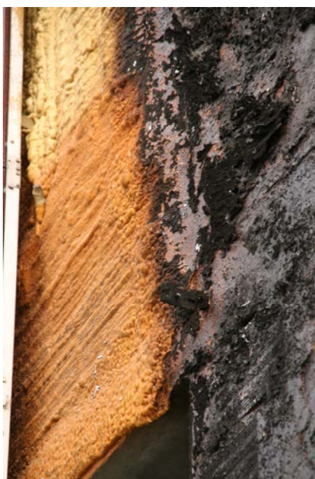
Fig. 5.4 – Isolamento térmico após incêndio, Abril 2008.
