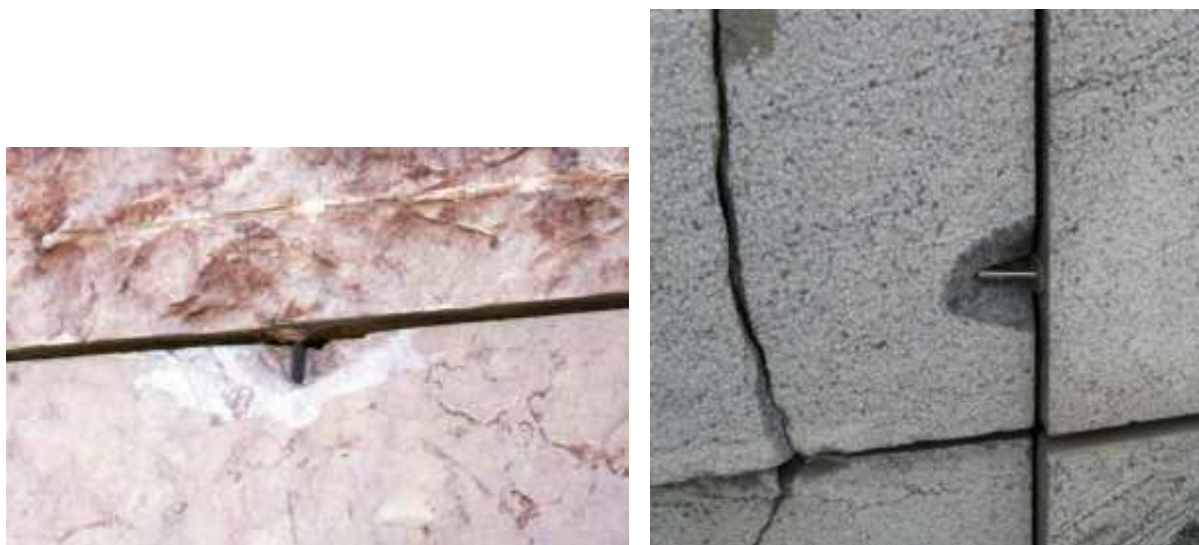
Fig. 2.36 – Quebra na zona de fixação.
