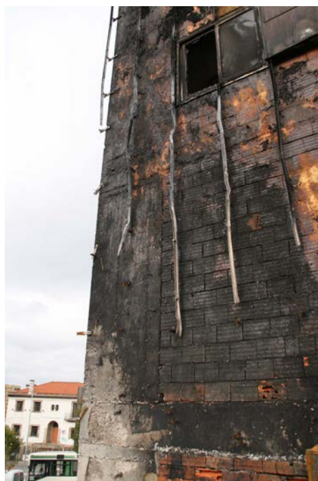
Fig. 5.3 – Pormenor de fachada após incêndio, Abril 2008.
