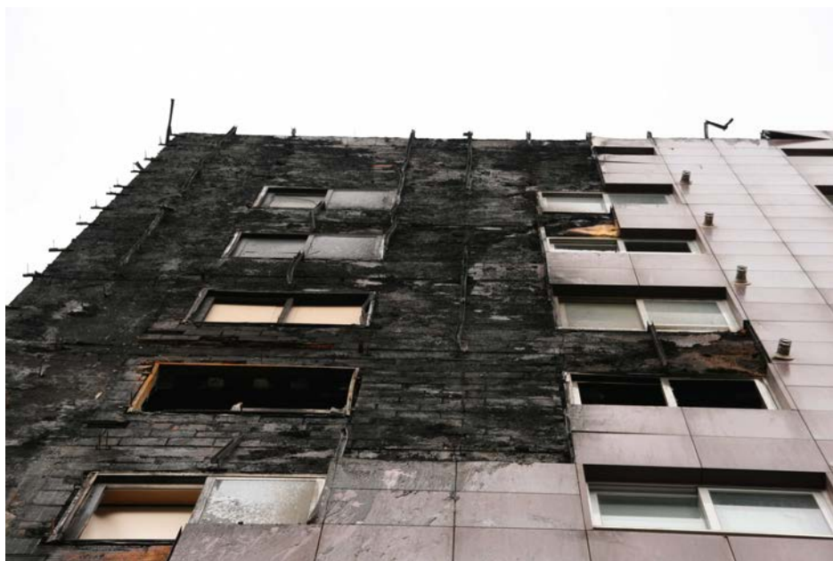
Fig. 5.1 – Fachada após incêndio, Abril 2008.
