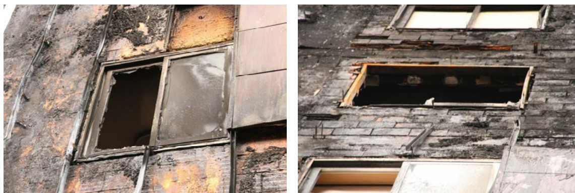
Fig. 3.2 – Abril 2008, Pormenor do prédio em V.N. Gaia, após extinção do incêndio.
