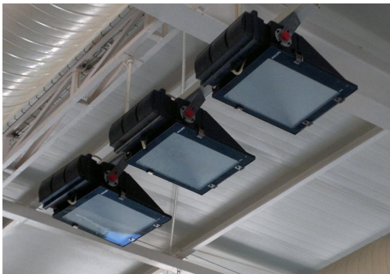
Figura 3.13 - Iluminação de grande potência na PMGN
