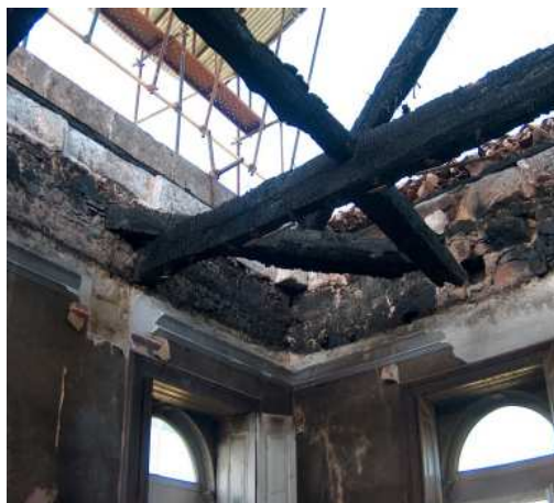
Fig. 4.7 - Aparência das vigas de madeira in situ após incêndio (Pereira, 2009).
