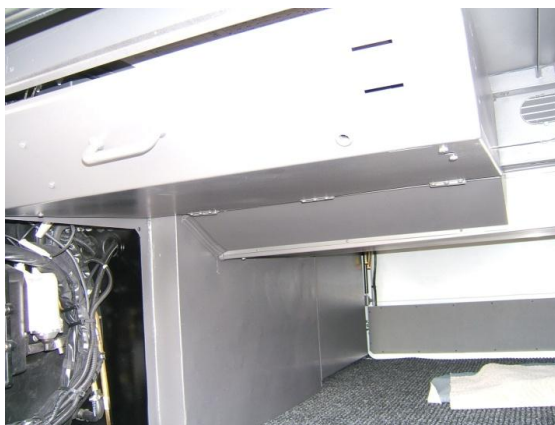
Figura 22 – Quadro eléctrico e blindagem para tapar as cablagens do mesmo
