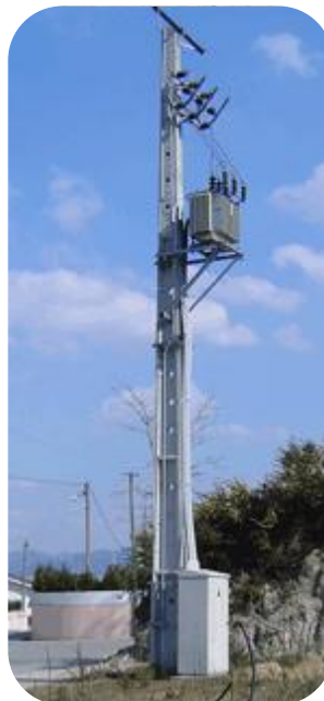
Figura 3.3 - Posto de Transformação Aéreo.
