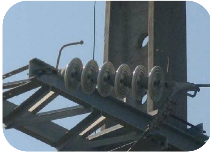
Figura 2.7 - Hastes de descarga instaladas numa cadeia de isoladores. [11]
