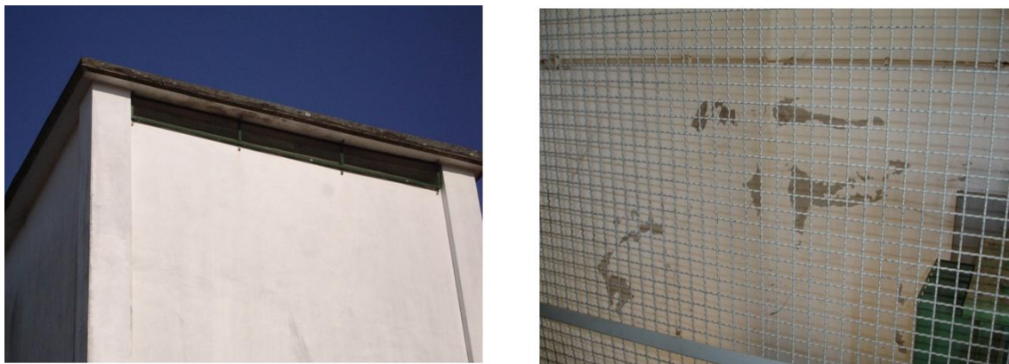
Figura 6.1 -. PT a precisar de manutenção (à esquerda verificamos a degradação da tela de impermeabilização, à direita podemos visualizar a degradação do revestimento interior (Pintura)).
