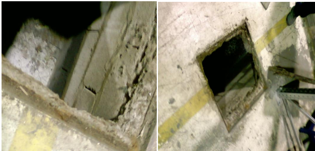
Ilustrações 11 e 12: Motivo da presença de humidade e irregularidades no piso do armazém.
