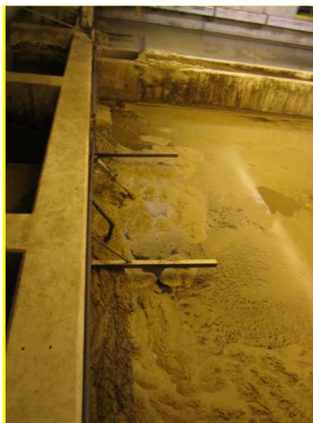
Figura 9 – Alastre de espuma ao decantador secundário (2011/03/31)
