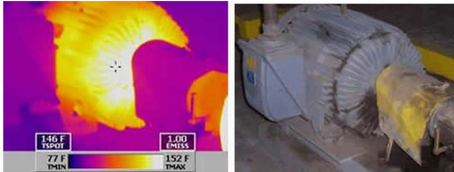
Figura 3.9: Motor em Sobreaquecimento por Excesso de Lubrificante[21]
