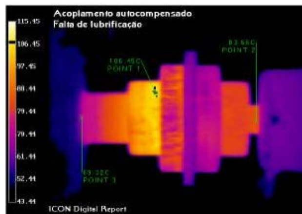
Figura 3.8: Termograma de Motor - Falta de Lubrificação[2]
