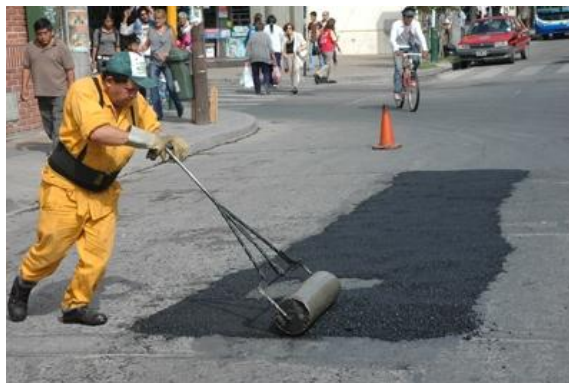
Fig. 2.15 – Compactação desadequada de uma mistura betuminosa (El Vie, 2008)
