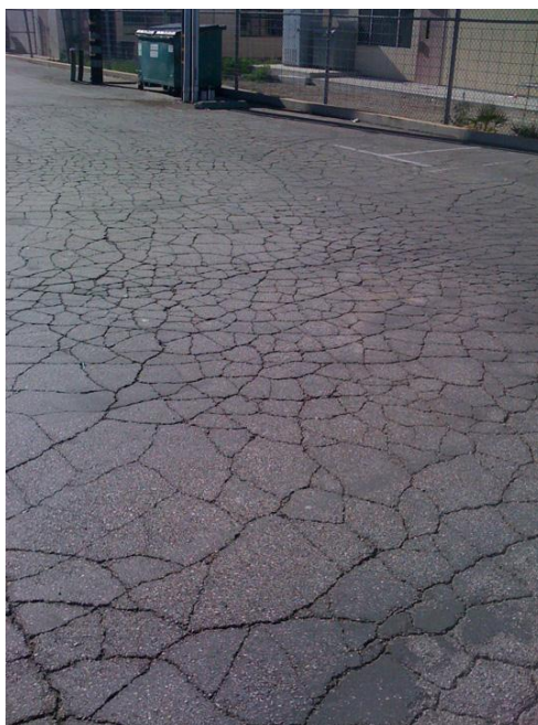
Fig. 2.16 – Aparecimento de fendas devido à baixa capacidade de carga de um pavimento flexível (Engenhariacivil, 2010)
