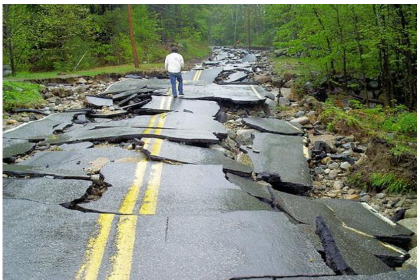
Fig. 2.13 – Pavimento em ruína (Engenhariacivil, 2010)
