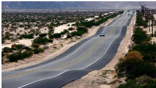
Fig. 2.2 – Exemplo de um pavimento irregular (Inovação Tecnológica, 2010)
