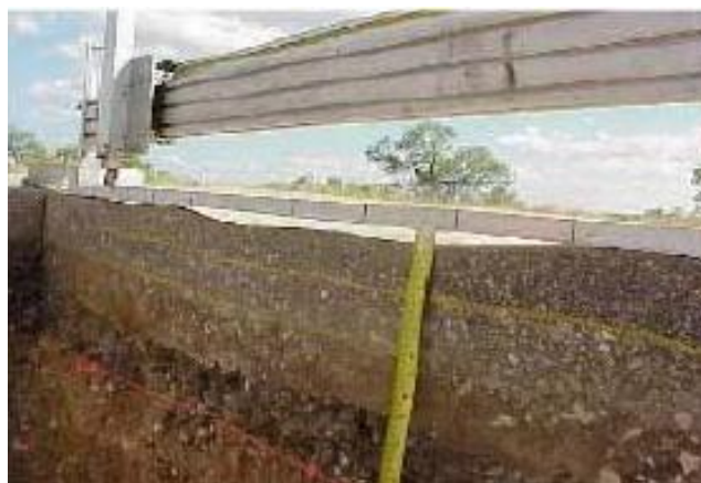
Fig. 2.9 – Pavimento flexível com deformação ocorrida na superfície (Pavimentos Rodoviários, 2009)
