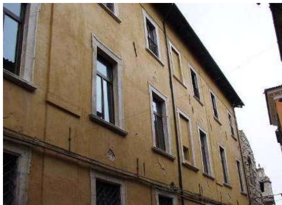
Figura 2. 12- Danos em estruturas de alvenaria reforçada (Costa et al, 2010).
