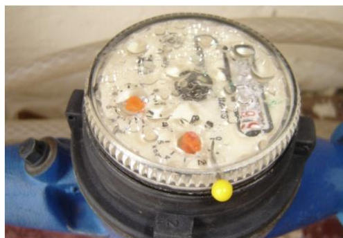
Fig. 2.32 Contador Violado com furo na cúpula (adaptado de Pereira, 2007)
