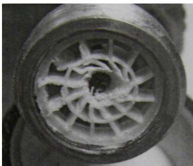
Fig. 2.30 Contador violado por colocação de objetos obstrutores no interior (Arregui, et al., 2006 (b))
