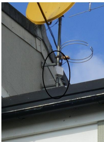
Fig. 2.40 Instalação de um concentrador no topo de um edifício
