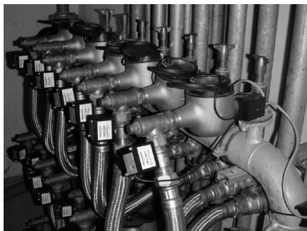
Fig. 2.42 Contadores dispostos em bateria (Medeiros, et al., 2007)
