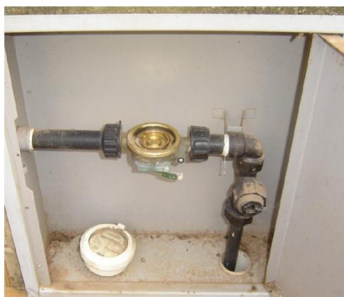
Fig. 2.31 Contador Violado com lacre retirado (adaptado de Pereira, 2007)
