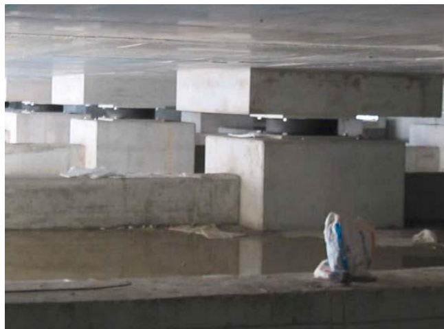
Figura 30 – Isolamento de base instalado no Hospital da Luz
