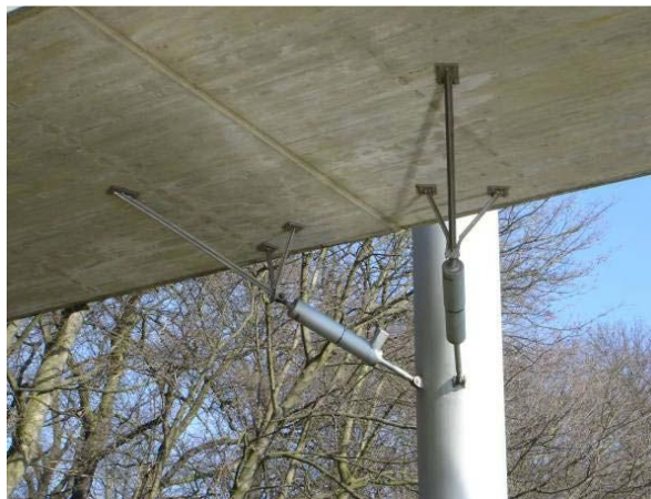
Figura 26 – Amortecedor viscoso instalado numa ponte pedonal [3]
