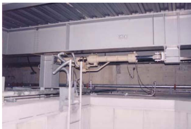
Figura 31 – Actuador instalado na estrutura do Applause Tower [3]
