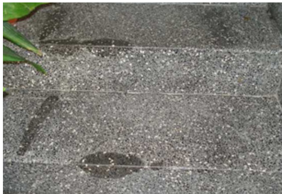
Figura 5.20 – Manchas e fissuras no marmoreite
