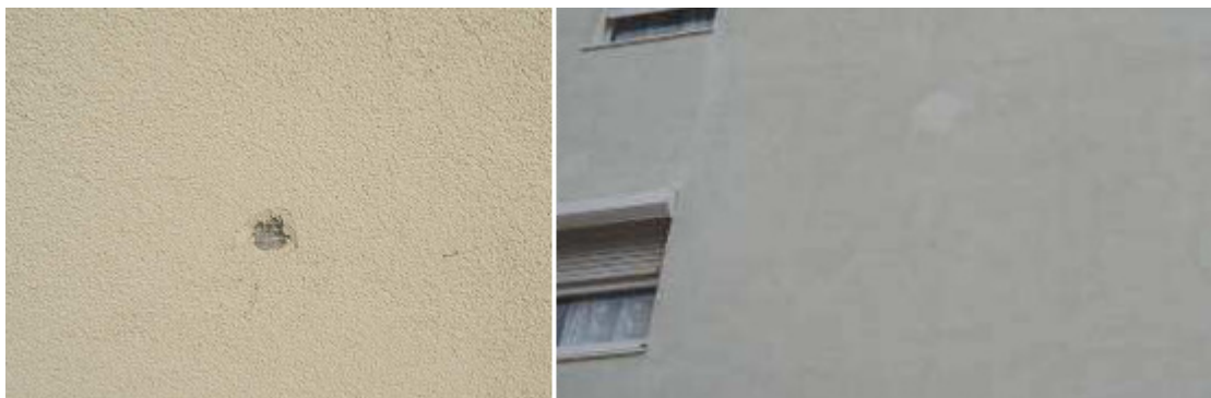
Figura 5.8 – Degradação mecânica do ETICS / manchas de coloração na pintura
