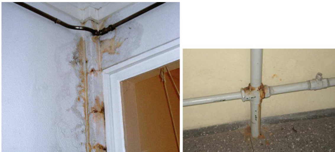
Figura 5.22 – Manchas na parede devido a fuga de água na canalização / Corrosão na tubagem
