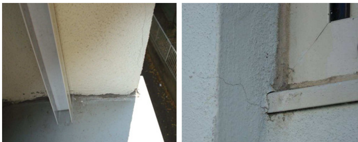
Figura 5.13 – Soleira mal concebida, facilita infiltrações / Acabamento inadequado
