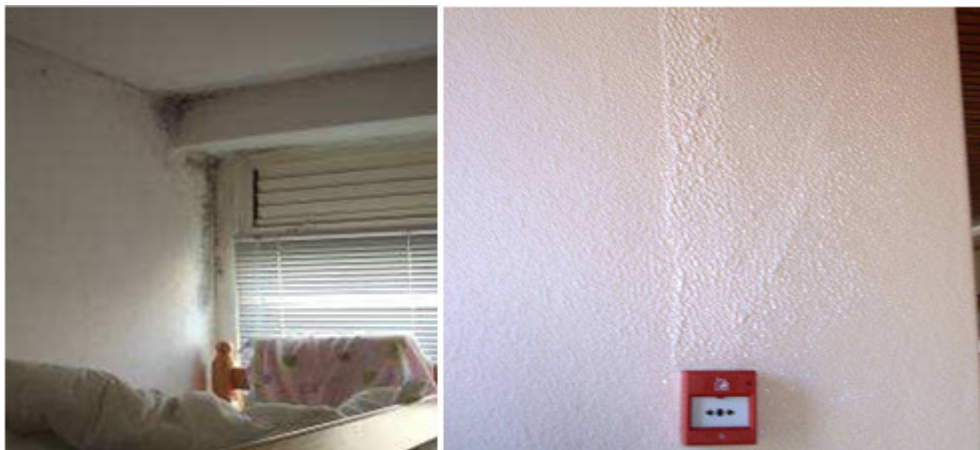
Figura 5.16 – Manchas e bolores / Empolamento de tinta
