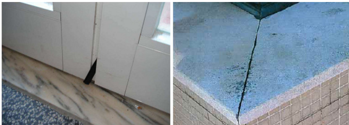
Figura 5.14 – Deficiente colocação de bites / Fissuração da soleira
