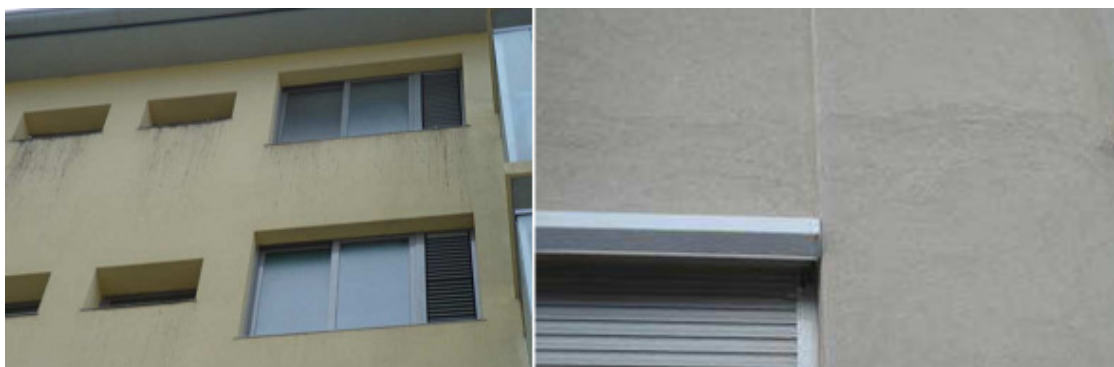
Figura 5.9 – Escorrências devido a sujidade / Acabamento irregular
