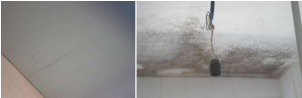
Figura 5.18 – Fissuras / Manchas e bolores
