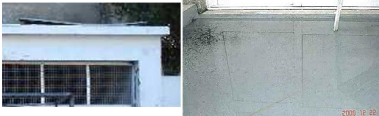
Figura 5.11 - Rufo danificado / Acumulação de água devido a inclinação reduzida
