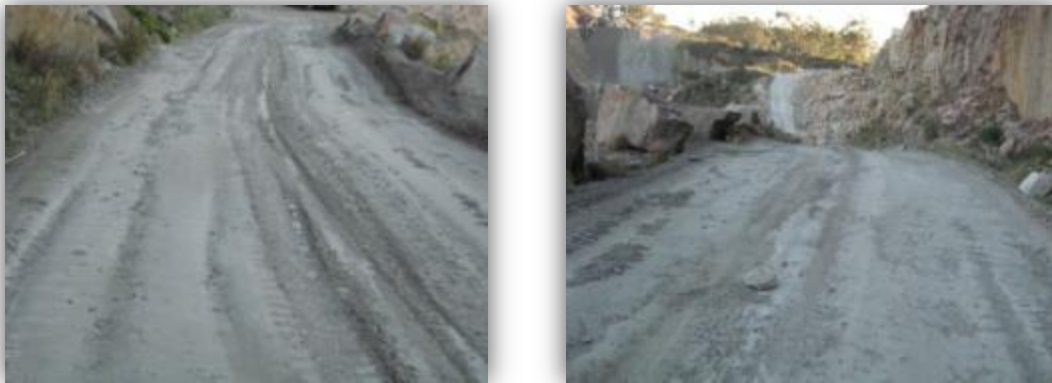
Figura 23: Exemplo do estado da pista de circulação – circuito pedreira
