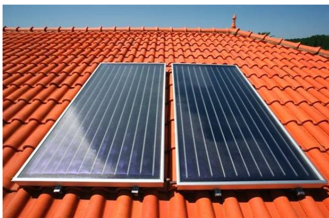
Figura 31 – Colectores solares de placa plana Ricworld Renewables, A200.
