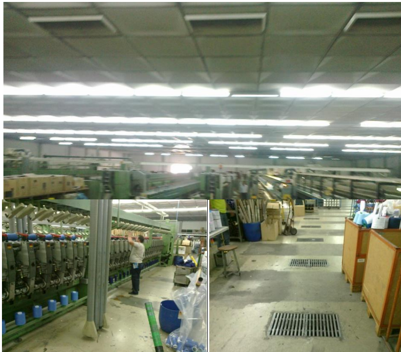
Figura 29 – Sistema de ventilação Bobinagem: insuflação (sup.), coluna de ventilação (esq.) grelhas de aspiração (dir.)
