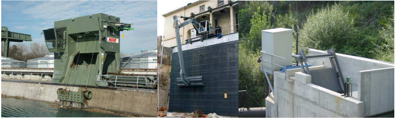
Fig. 2 - Limpa grelhas de cabos, hidráulico e de correntes
