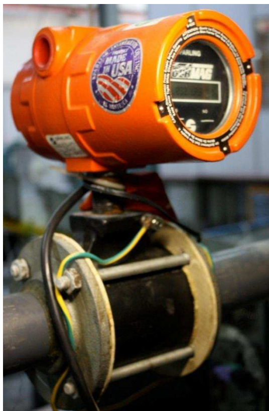
Figura 3.6. Medidor de caudais electromagnético utilizado.
