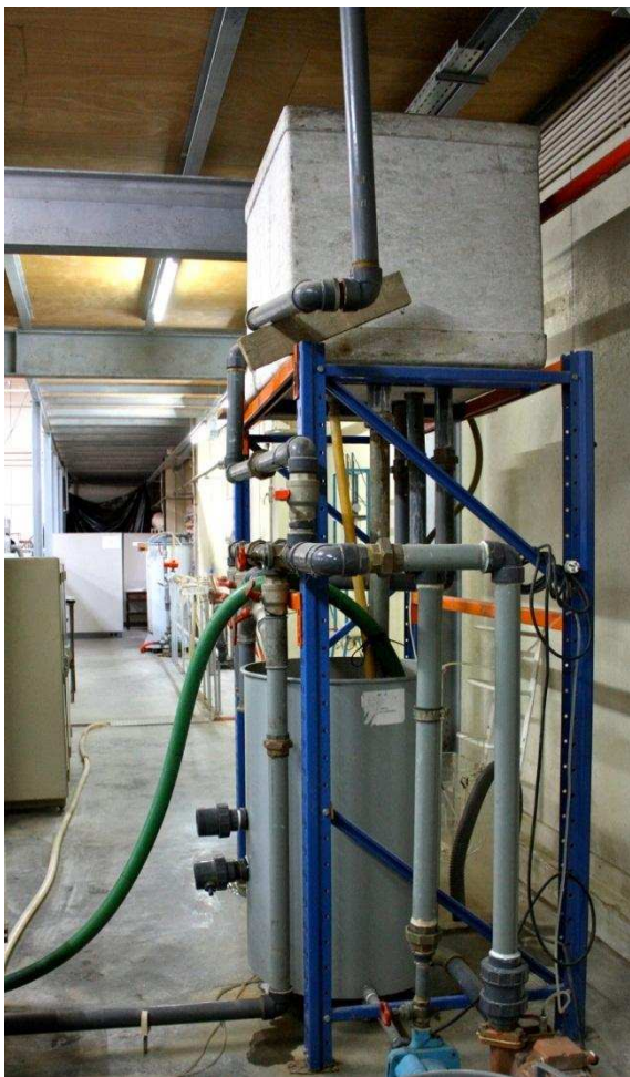
Figura 3.2. Reservatório de alimentação da instalação.
