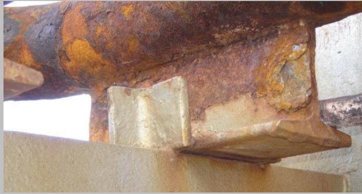
Figura 22 - Fenómeno de corrosão galvânica entre a linha e o suporte
