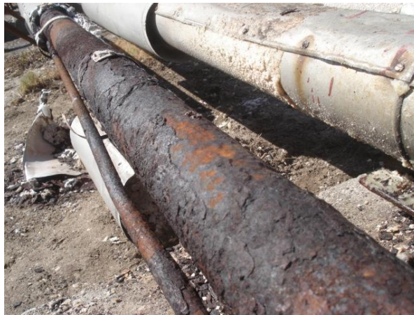
Figura 7 – Linha de parafina com traçagem, desisolada com camadas de óxidos visíveis
