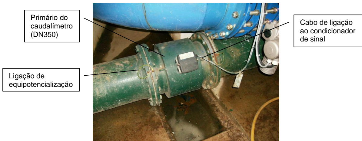
Fig.4.4. – Primário de caudalímetro electromagnético tubular instalado na conduta de distribuição de um reservatório
