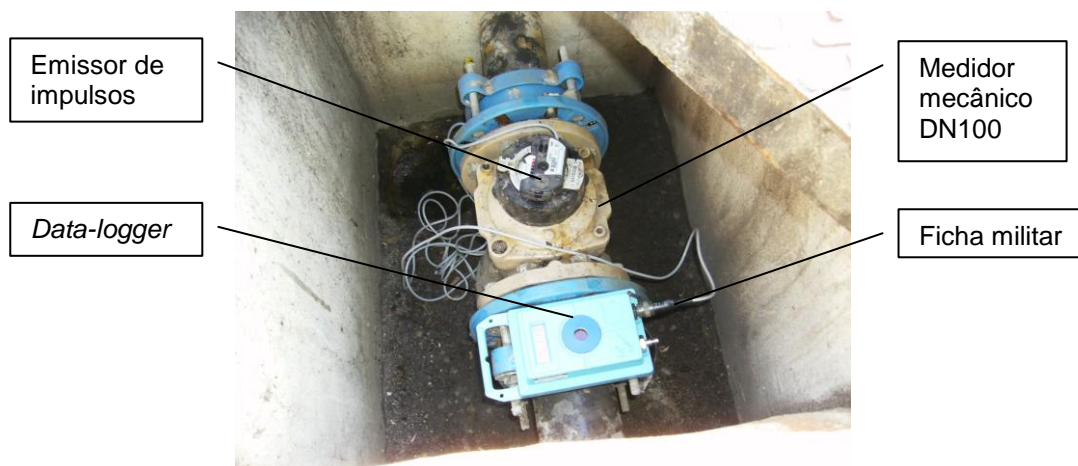
Fig.4.6. – Solução de medição de caudal em ZMC com contador mecânico
