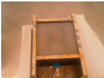
Figura 83 - Vazamento da 1ª metade
