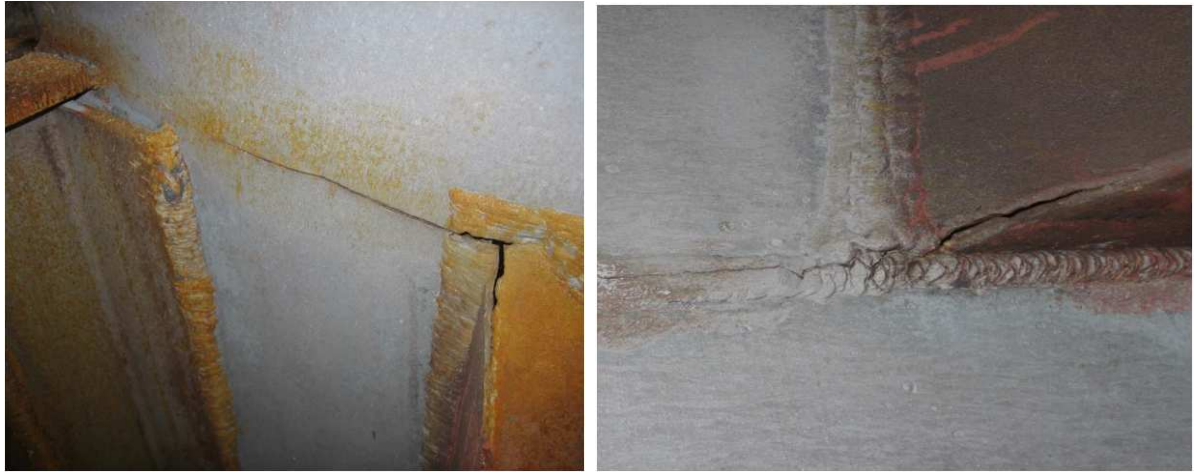
Figura 2.17 – Fotografias de fendas surgidas em zonas de elevadas concentração de tensões
