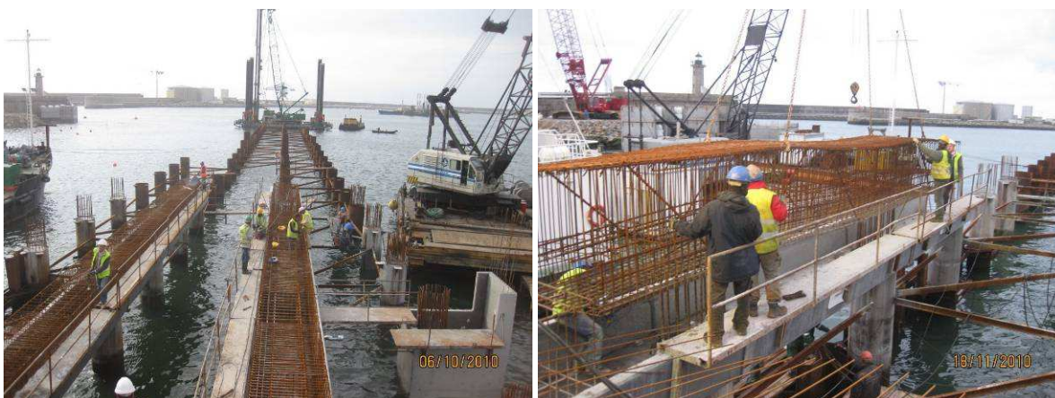
Fig. 4.19 – Exemplo de recurso a guarda corpos nas operações de colocação de armaduras na obra exemplo.
