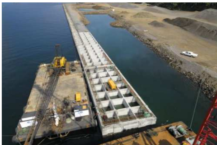
Fig. 2.48 – Porto de Malabo, Guiné Equatorial (enchimento de caixotões de um muro de gravidade) [58].
