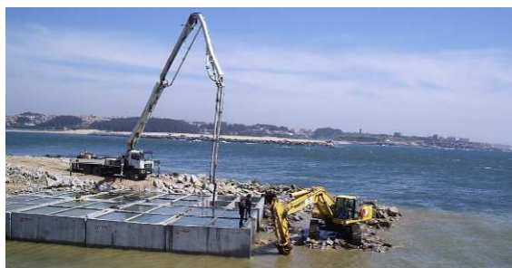
Fig. 2.81 – Aterro e enrocamento como obra auxiliar para a colocação de aduelas (Molhes do Douro) [17].
