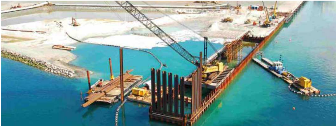
Fig. 2.76 - Construção do porto de águas profundas de Northport, Nova Zelândia com estacas-prancha, recorrendo a equipamentos flutuantes (várias actividades construtivas em simultâneo) [64].
