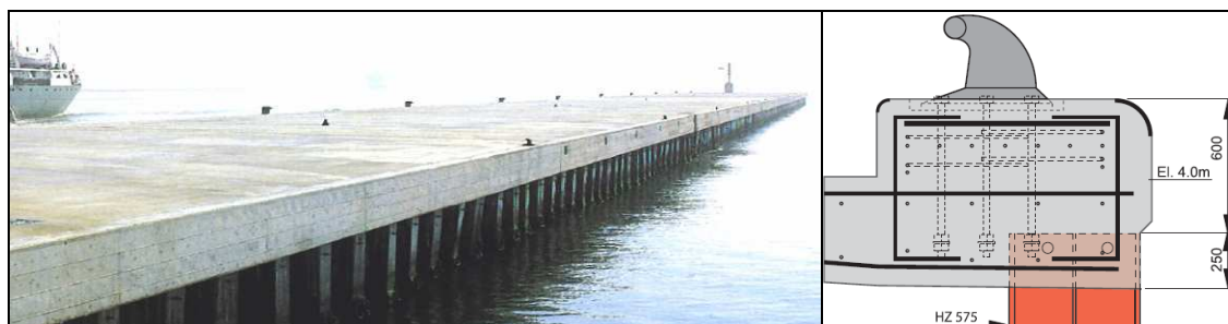
Fig. 2.80 - Cais com cortina de estacas-prancha metálicas com viga de coroamento em betão armado [17] e [64].
