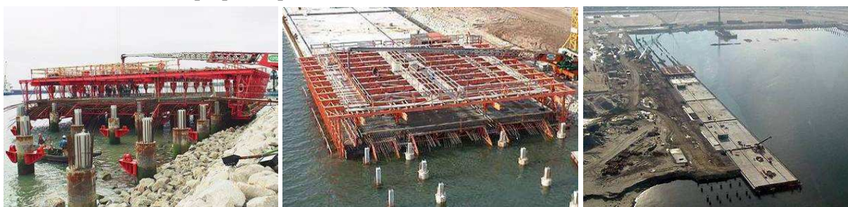
Fig. 2.66 – Utilização de cimbra auto-lançada na construção do Terminal Norte e Terminal RO-RO do Porto de Aveiro [63].
