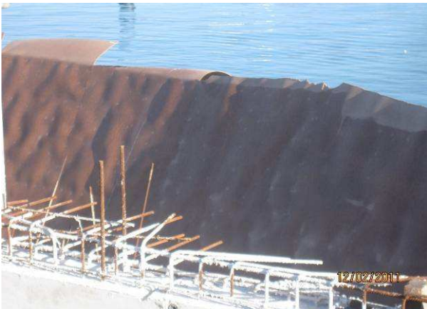
Fig. 4.2 – Cofragem não conforme da Ilha Ecológica.
