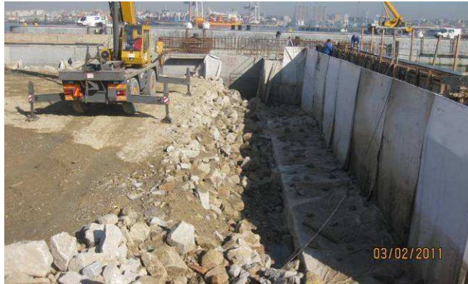
Fig. 2.47 – Aterro de tardoz na obra exemplo (TOT, filtro geotêxtil e material de aterro geral).
