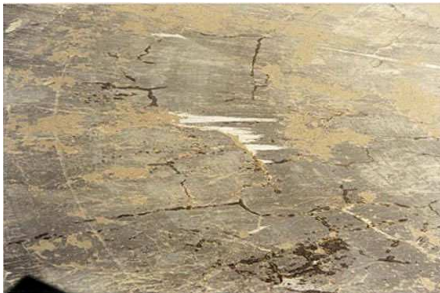
Figura 3.3 – Fendilhação da laje de fundo de um depósito circular
