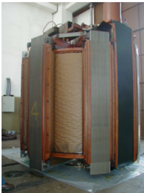
Fig. 2.7 Parte activa de transformador tipo core , monofásico, após descubagem
