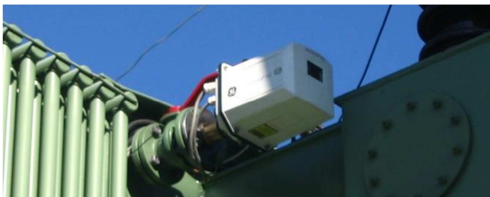
Fig. 3.16 Montagem de sensor de gases Hydran M2 - indicação gás único
