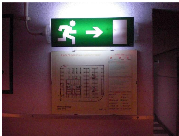
Fig. 5.34 – Iluminação de emergência
