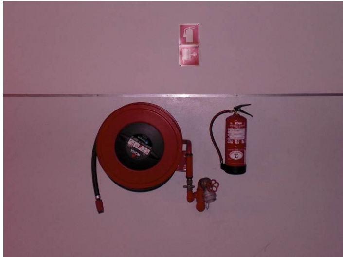
Fig. 5.36 – Meios de primeira intervenção
