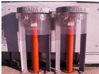
Fig. 5.2 – Coluna seca existente junto à fachada poente da Torre
