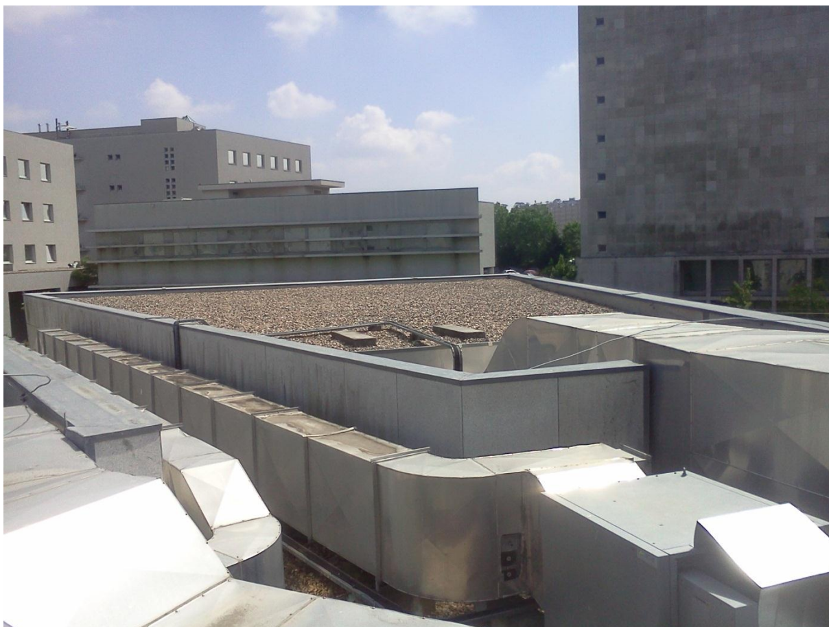
Figura 69 – Conduções de AVAC no telhado da sala.
